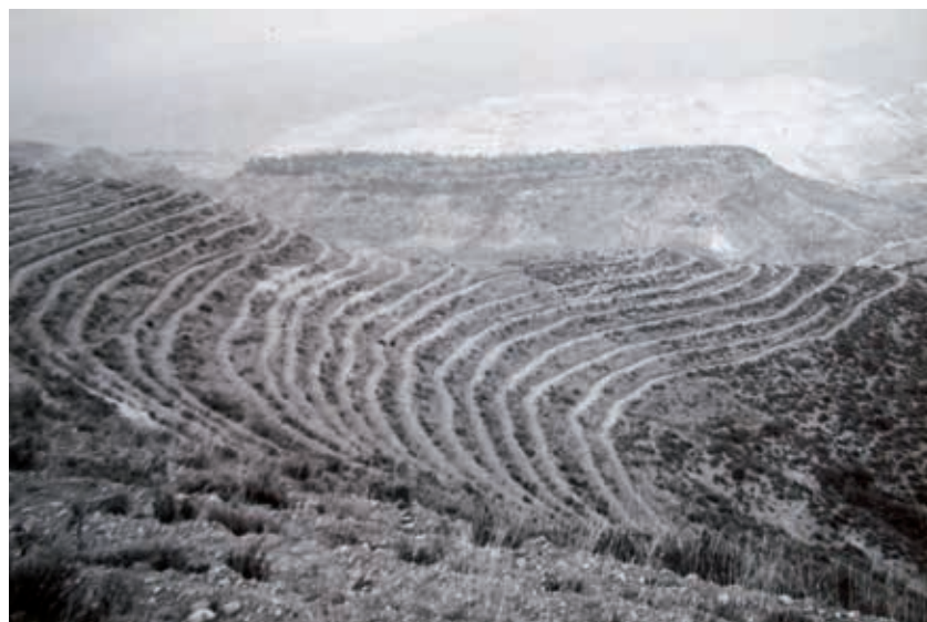
Figura 7 - Monte Valfuró de Puente de Montañana (Ribagorza) en 1958 durante la fase de apertura de fajas
