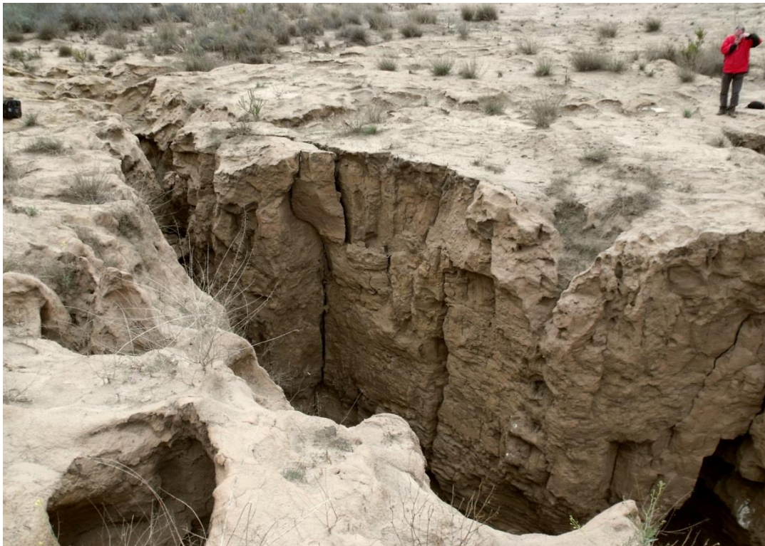
Figura 16. Aspecto de la gran cárcava formada en el dique de la presa 977-II-4-028, la cual se conecta con un complejo sistema de cárcavas, regueros y canales de erosión interna en el vaso.
