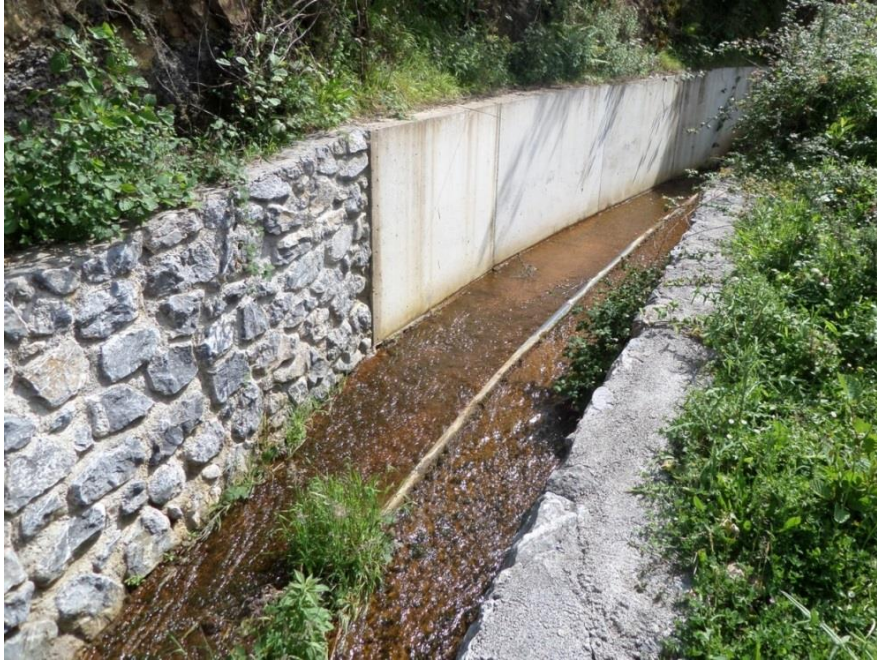
Canal perimetral de la presa minera La Troya (Mutiloa, Guipúzcoa).
