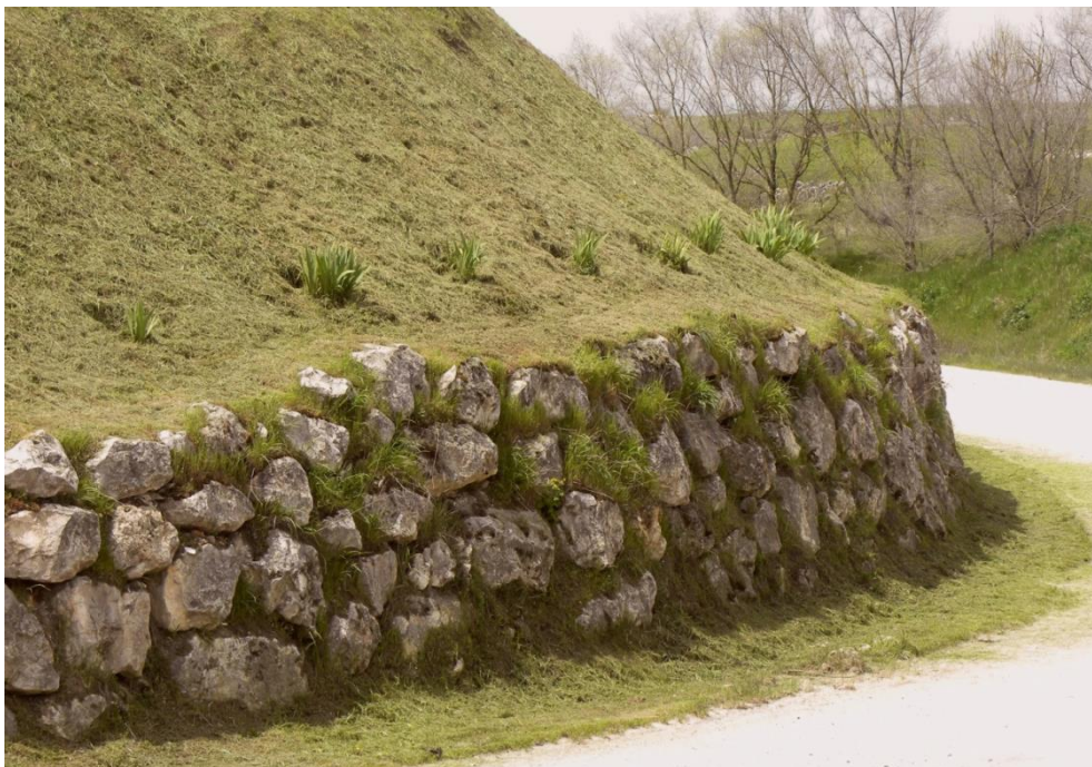
Muro de escollera que sostiene residuos de construcción y demolición en las instalaciones de RESBUR (Burgos).
