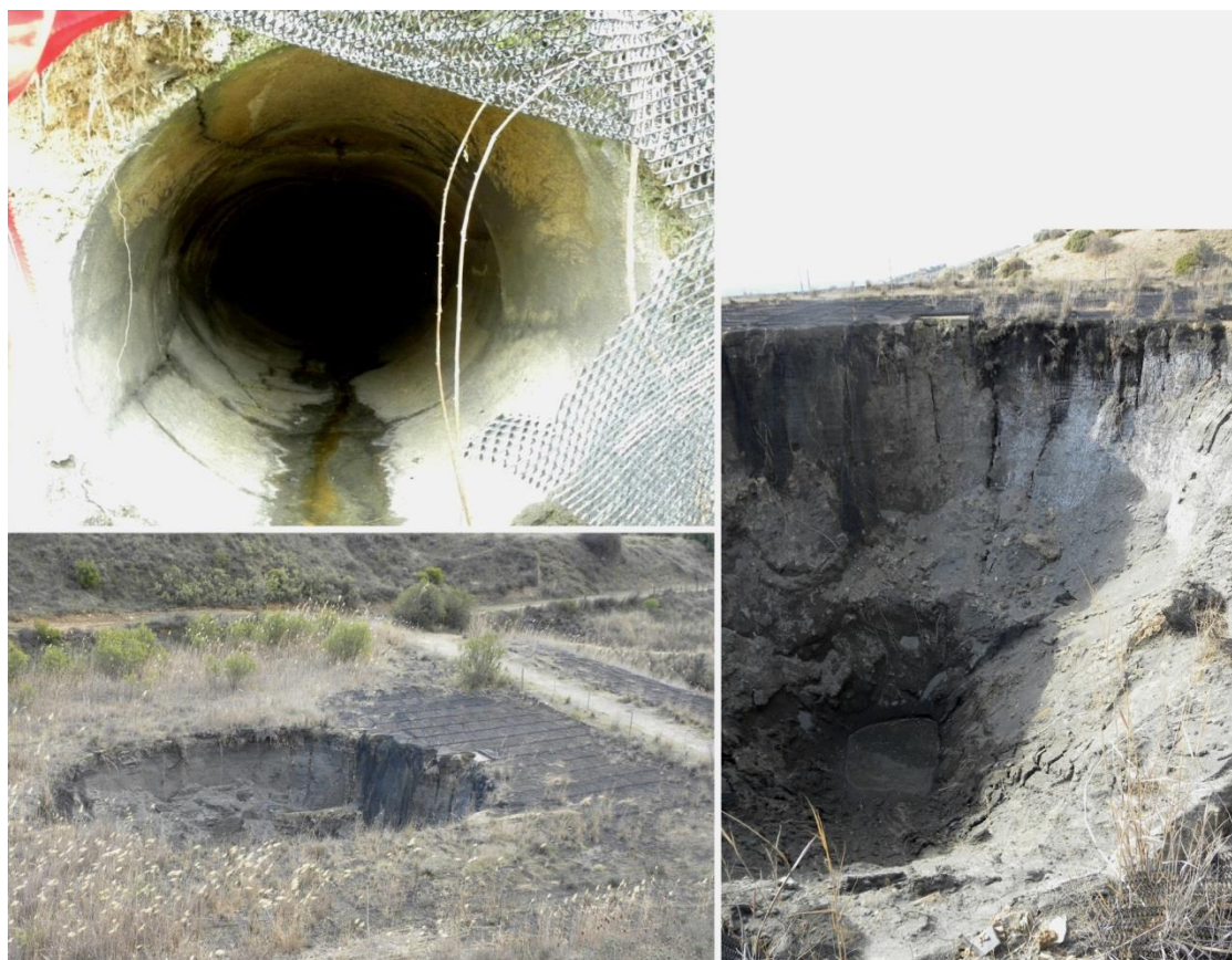
Figura 48. Detalles del fenómeno de hundimiento o colapso observado en campo durante la visita en febrero de 2012. Los materiales del vaciado salieron por el drenaje de fondo (arriba a la izquierda) depositándose a lo largo del cauce del río Campana.
