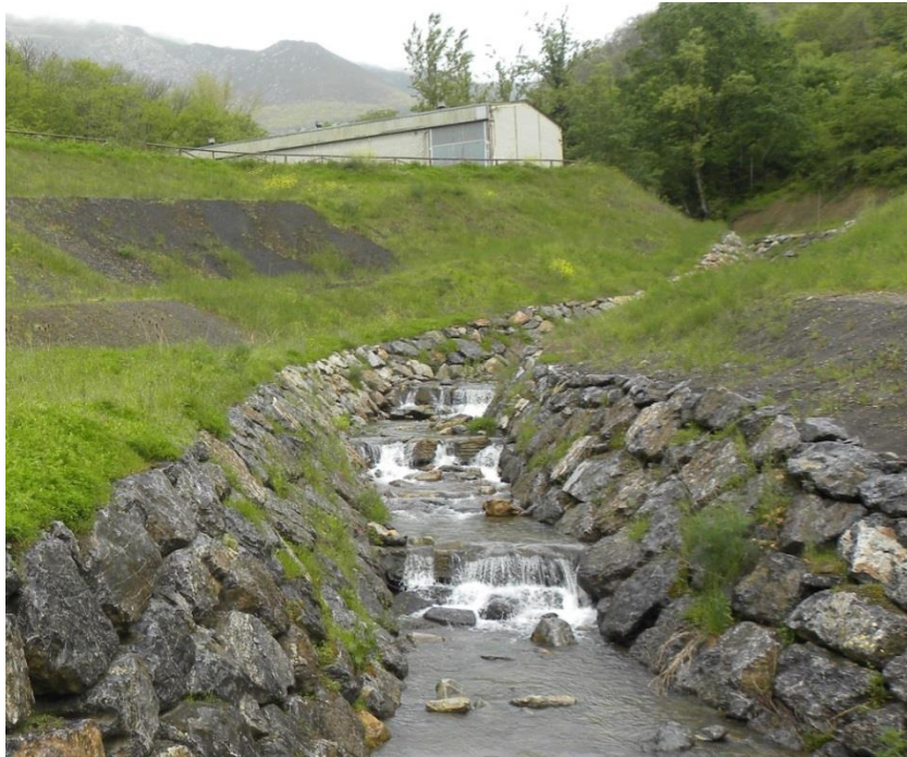
Canal perimetral (o protección de un cauce natural) de una pequeña escombrera en Bárzana (Asturias).
