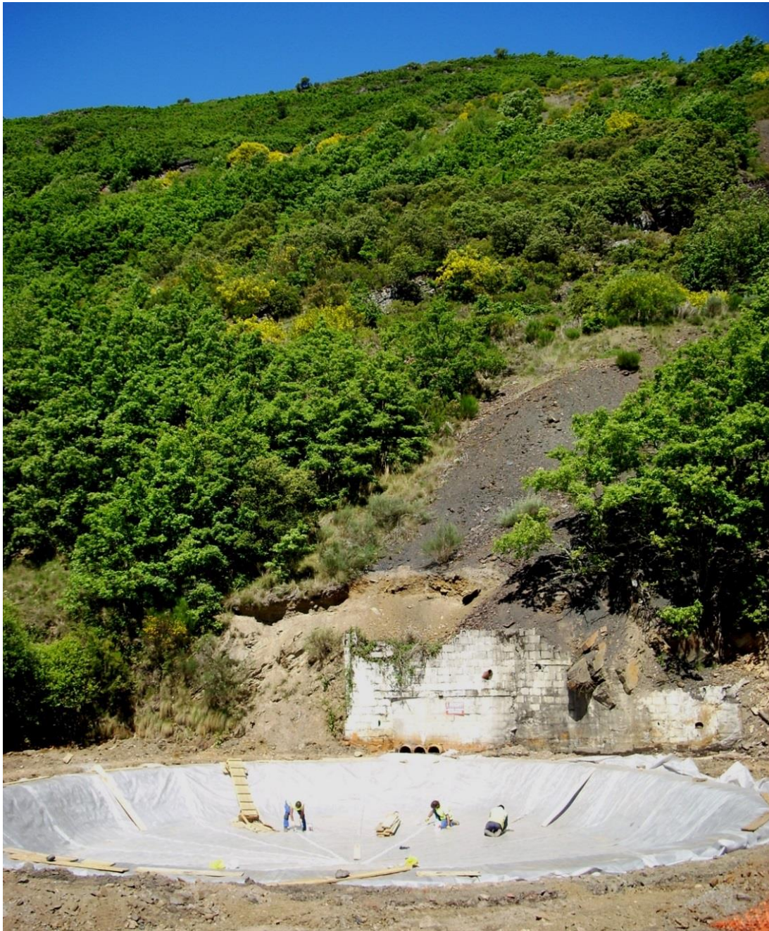
Figura 70. Construcción de un sistema SAPS en las proximidades del arroyo Rodrigatos (León).
