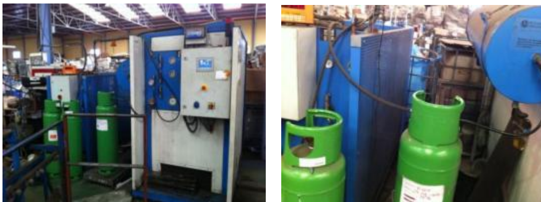
Fotografías 5.2.4.- Detalle de la máquina de extracción de gases y aceites. Detalle del almacenamiento del aceite y de los gases en bombonas separadas e identificadas.
