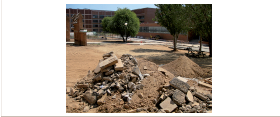
Figura 4.16. Apilamientos de material de la obra, no cubiertos ni regados susceptibles de resuspensión en la Zona Universitaria de Barcelona, obra pública 2009
