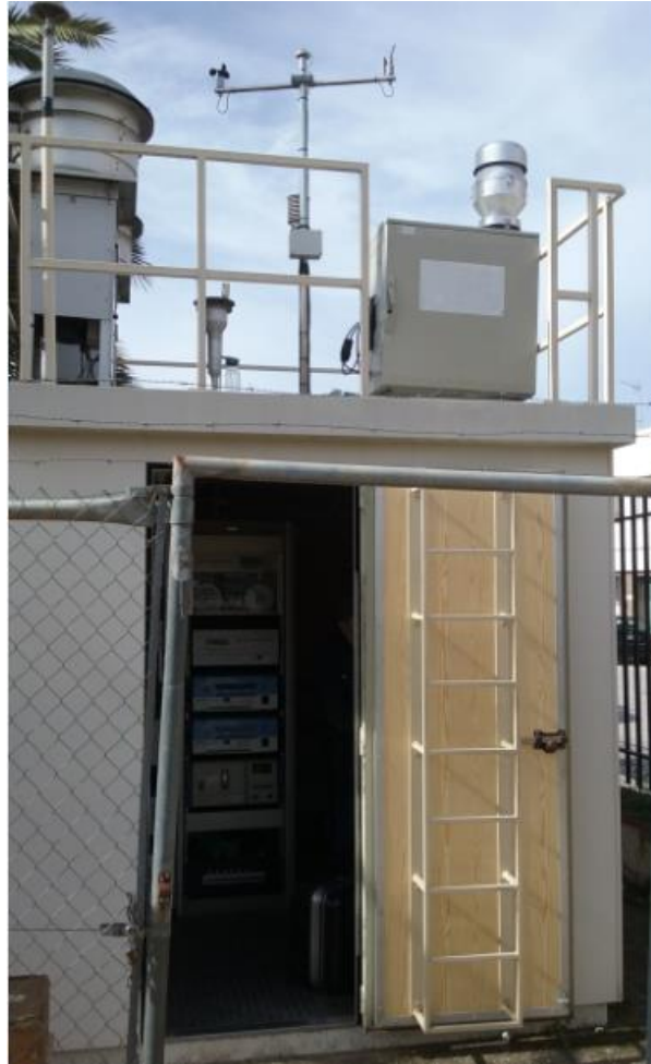
Figura 5: Captador de alto volumen secuencial MCV CAV-A/MSb instalado en el techo de la cabina por la Consejería de Medio Ambiente para realizar el muestreo para llevar a cabo los estudios de contribución de fuentes.
