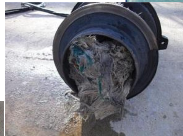
Fuente: Consorcio de Aguas Bilbao Bizkaia
