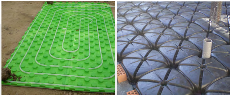
Suelo radiante, ejemplo de utilización de plásticos Forjado sanitario con cubetas de plástico
