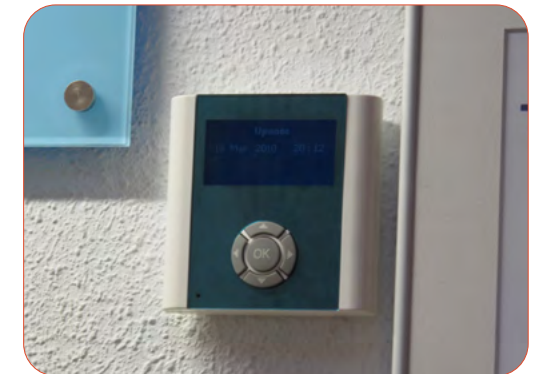
Regulación y control en sistema de suelo radiante
