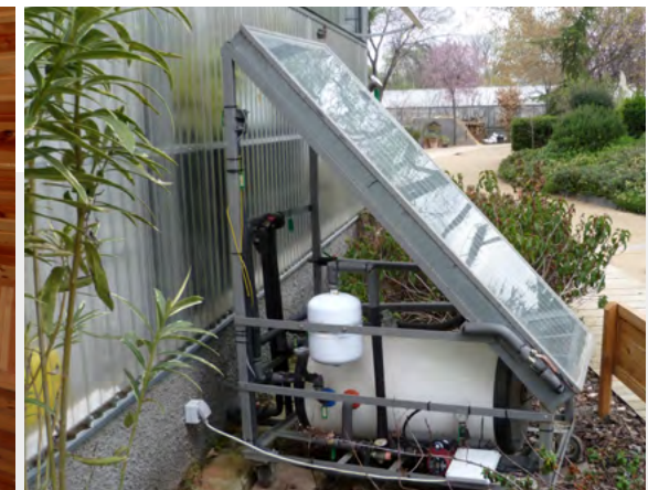
Instalación solar térmica
