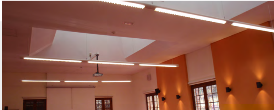
Iluminación con luminarias de bajo consumo y sectorizada
