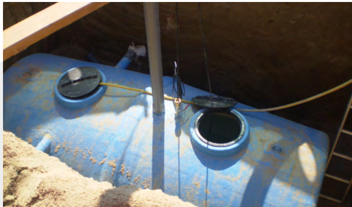
Depósito de recogida de aguas pluviales
