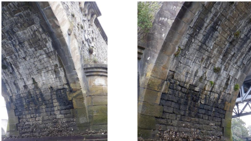
Figura 30. Presencia de humedades y calcificaciones en bóvedas
