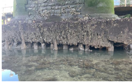
Figura 21. Pila 4. Pilotes descubiertos
