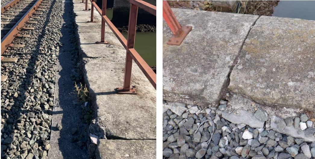
Figura 26. Daños en impostas
