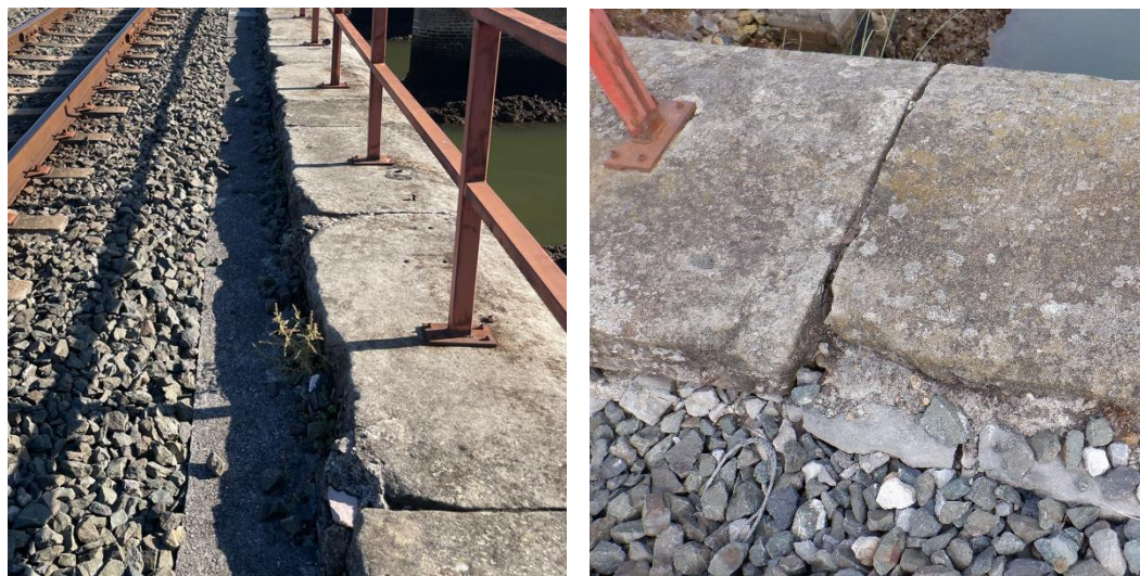
Figura 14. Daños en impostas
