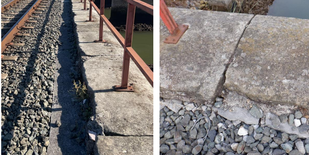
Figura 35. Daños en impostas
