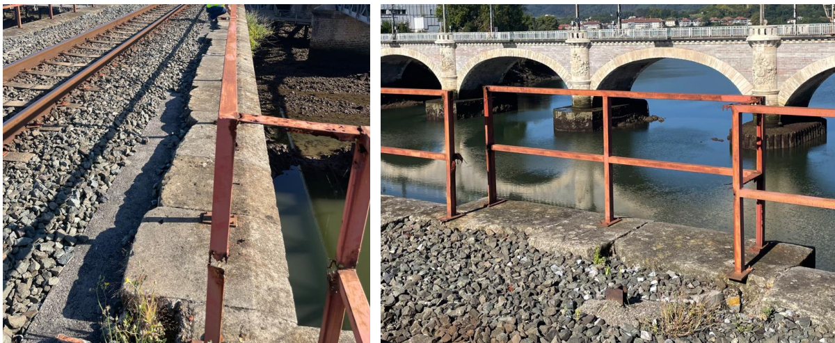
Figura 27. Daños en barandillas debidos a la oxidación del acero
