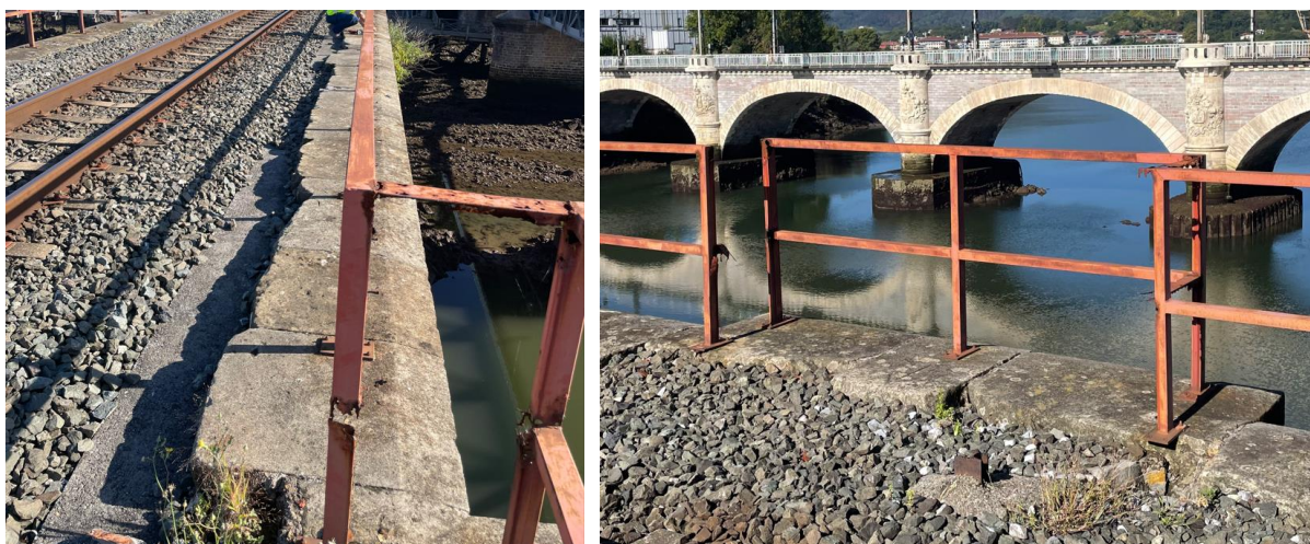
Figura 15. Daños en barandillas debidos a la oxidación del acero
