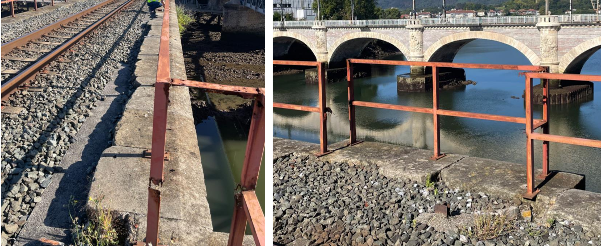
Figura 32. Daños en barandillas debidos a la oxidación del acero
