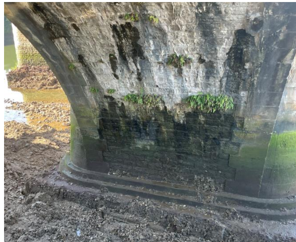
Figura 26. Humedades y verdín en carrera de mareas
