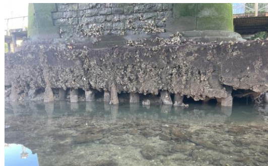
Figura 26. Pila 4. Pilotes descubiertos
