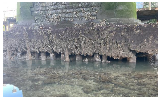
Figura 30. Pila 4. Pilotes descubiertos
