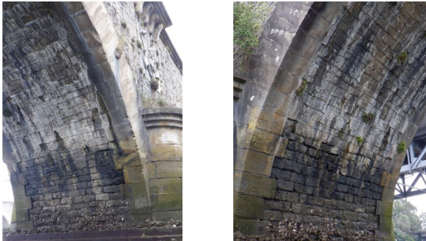
Figura 43. Presencia de humedades y calcificaciones en bóvedas
