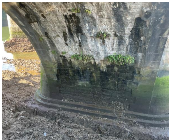
Figura 9. Humedades y verdín en carrera de mareas
