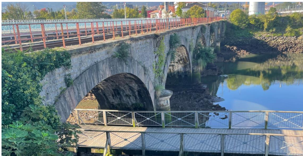
Figura 44. Presencia de vegetación ruderal en las grietas y fisuras del puente
