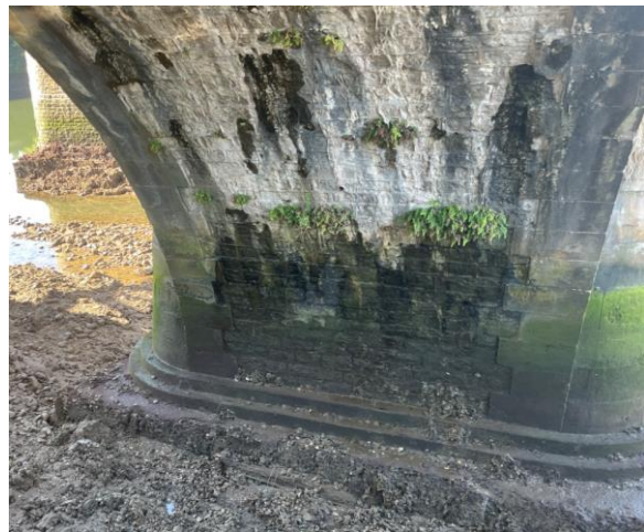
Figura 22. Humedades y verdín en carrera de mareas
