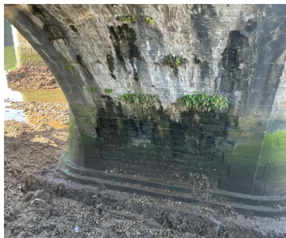
Figura 19. Humedades y verdín en carrera de mareas
