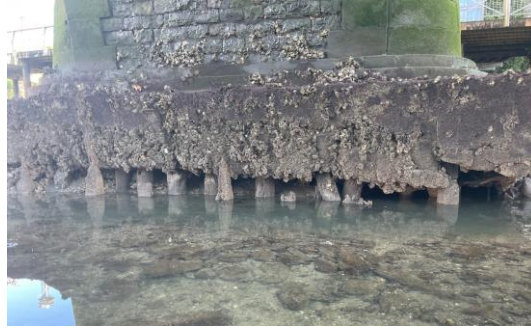
Figura 13. Pila 4. Pilotes descubiertos
