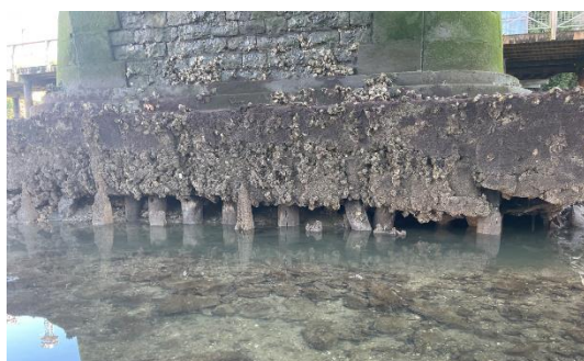
Figura 5. Pila 4. Pilotes descubiertos
