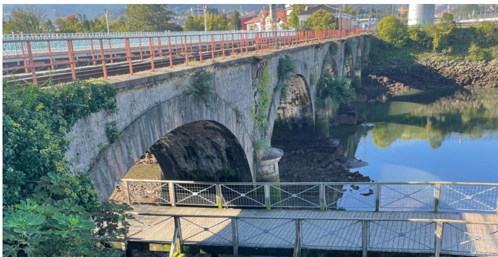
Figura 33. Presencia de vegetación ruderal en las grietas y fisuras del puente
