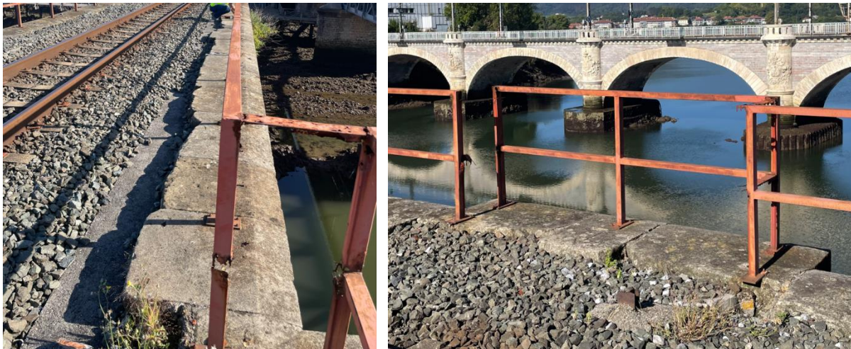
Figura 36. Daños en barandillas debidos a la oxidación del acero
