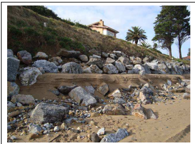
Antes de la actuación
