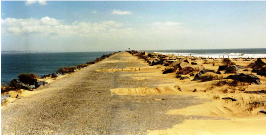
Figura 4.45: Actividad eólica sobre el dique de Juan Carlos I de Huelva (CEDEX 1991)
