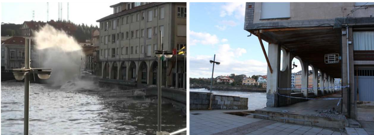
Figura 3.22. Luanco: rebase sobre la defensa del paseo marítimo (panel izquierdo). Desperfectos tras el temporal (panel derecho).
