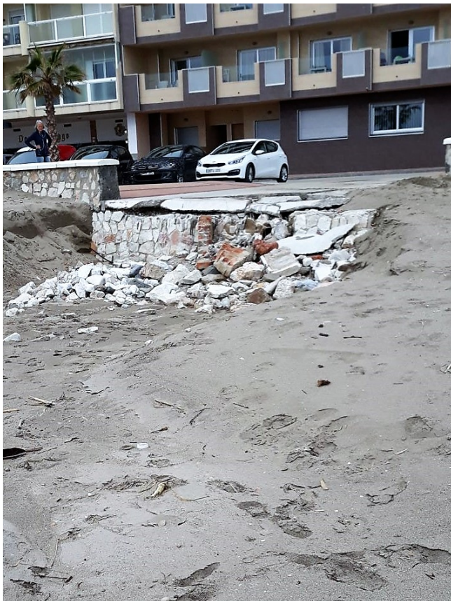
EROSION POR LLUVIAS.
