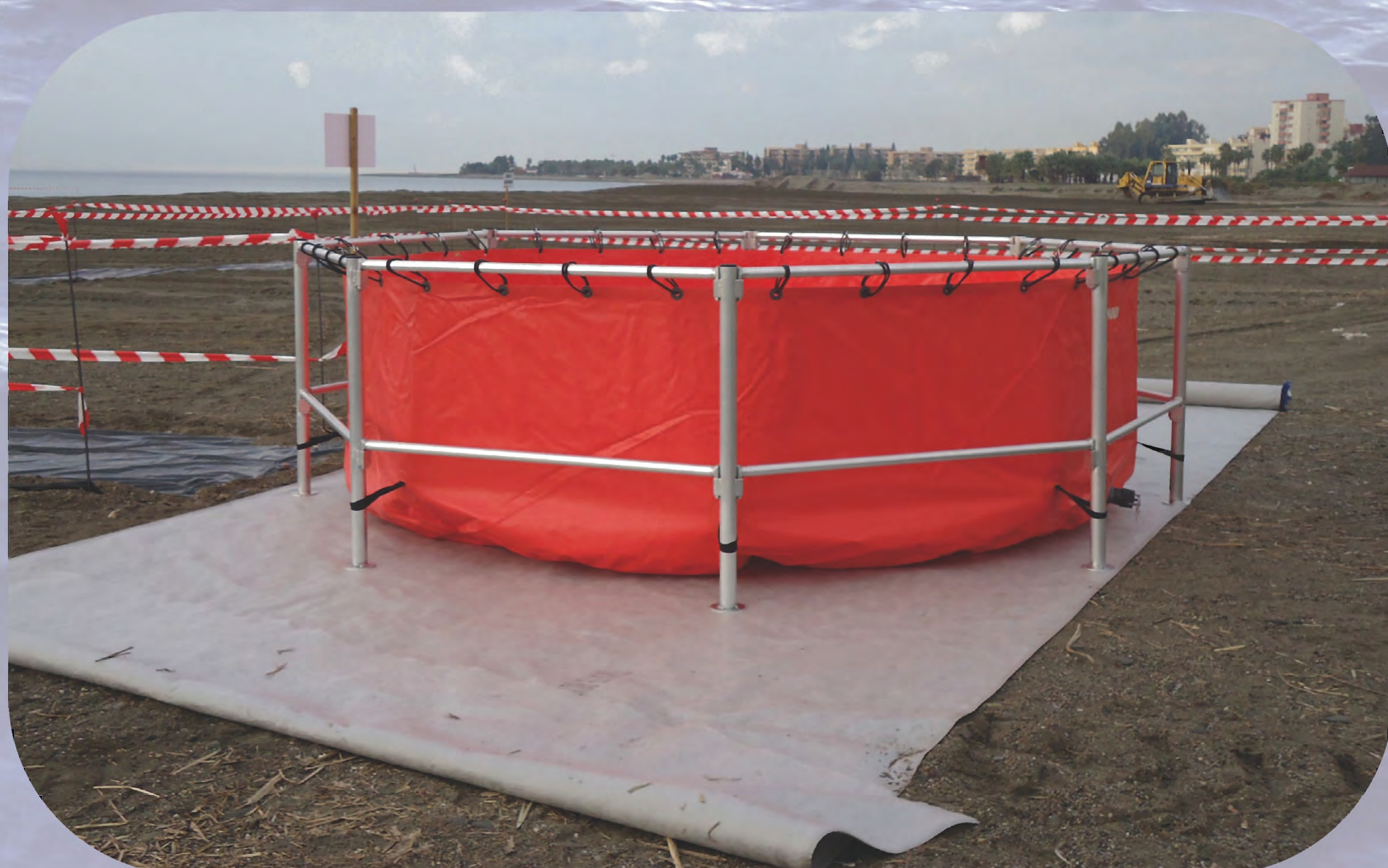
DEPÓSITOS DE ALMACENAMIENTO DE RESIDUOS
