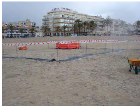
Figura 4: Pasillos y almacenaje de residuos
