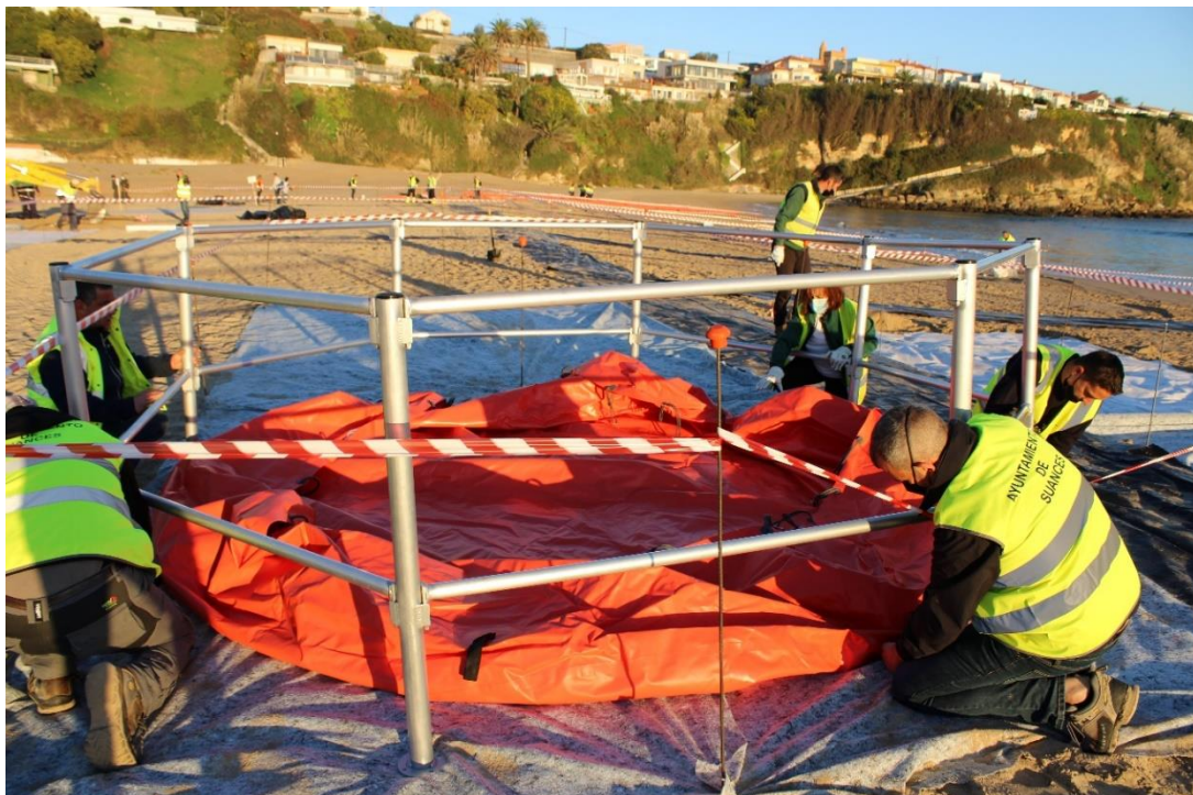
Ilustración 28. Montaje del Fast tank en la zona de almacenamiento temporal de residuos.
