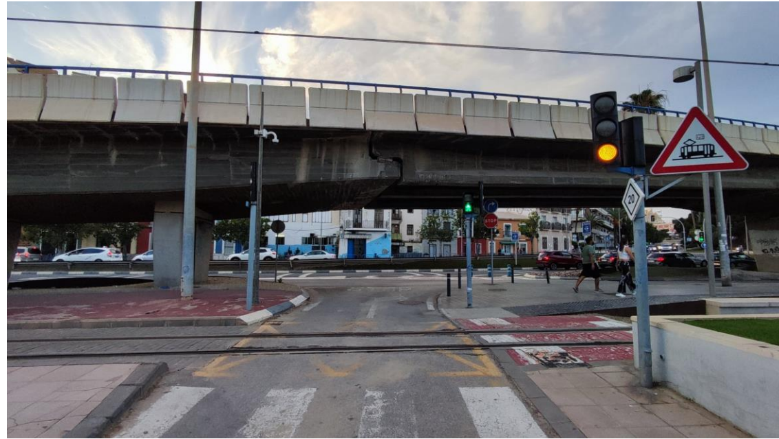
Ilustración 7. Entrada y salida provisional de vehículos de obra y elementos a retirar/modificar (semáforo, bolardos, señal vertical, pozos de registro, etc.) para modificación de trazada provisional de la calzada de acceso.
