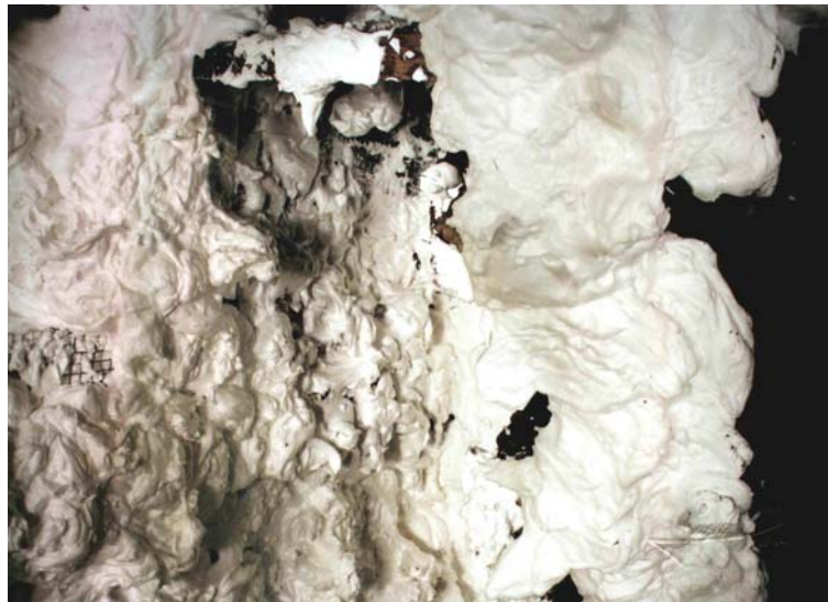
Figura XXIII. Detalle de la adherencia de la espuma a los diferentes componentes de entibación (hierro y madera).
