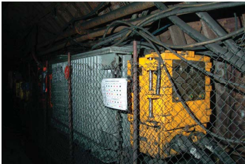
Figura 47. Transformador en una obra subterránea
