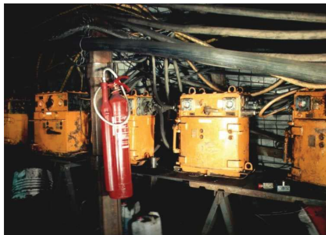
Figura 81. Subestación eléctrica con extintor
