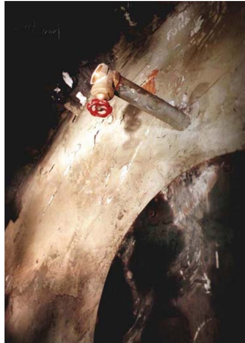
Figura XXVI. Detalle de tubos de 2" con llave de compuerta para tomar muestras de gases y cierre de guillotina (chapa atornillada al tubo de 800 mm de diámetro que traspasa el tabique, existiendo entre el tubo y la chapa una junta de goma para evitar fugas
