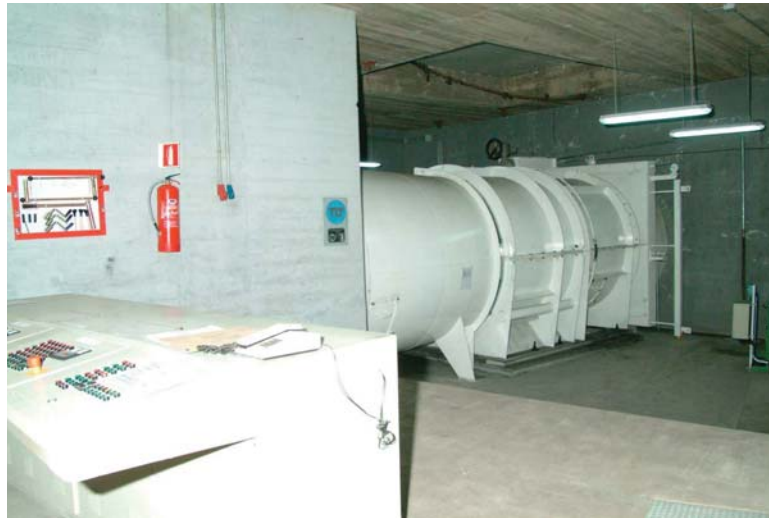
Figura 7. Ventilador principal de una mina
