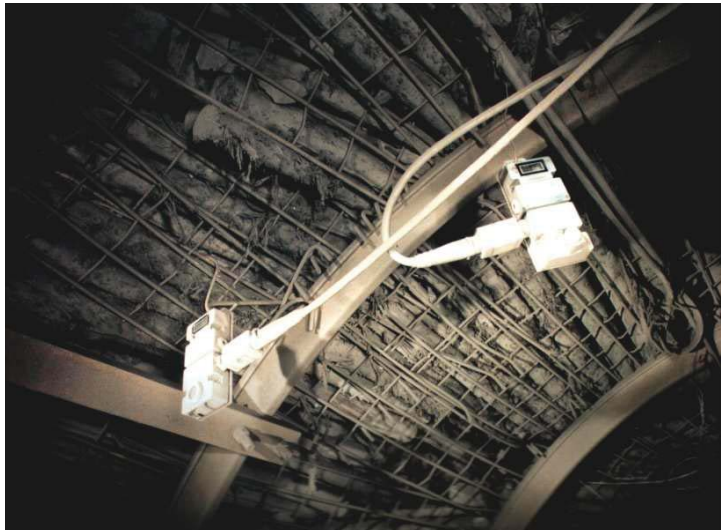
Figura 51. Detectores de CO y CH 4 ubicados en el retorno de ventilación.
