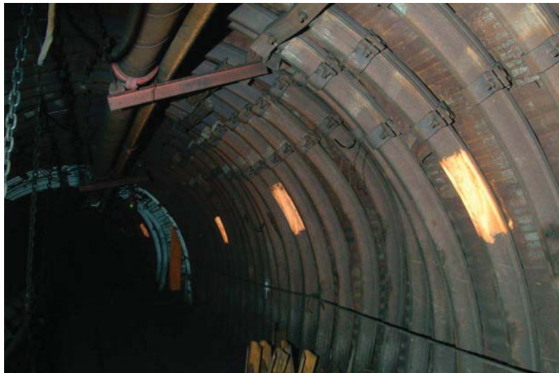
Figura 68. Señalización con pintura reflectante y cuerdas de salvamento
