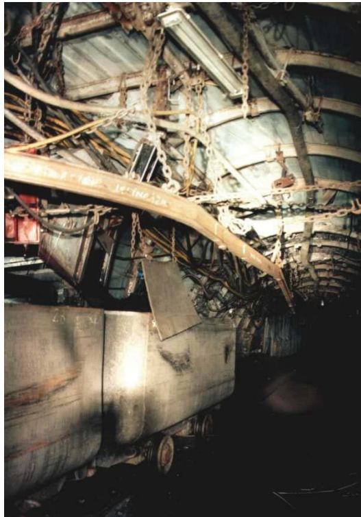
Figura 45. Revestimiento no combustible de la galería en la zona de cabeza de cinta transportadora.
