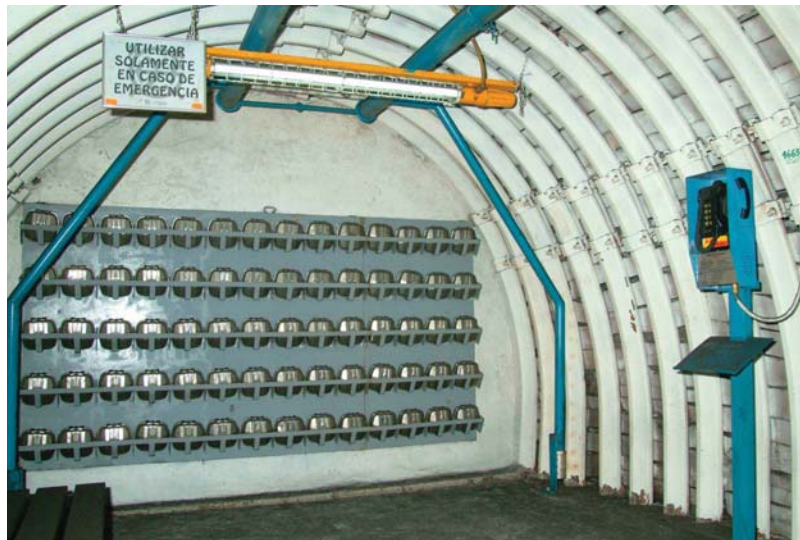
Figura 66. Refugio de mina con teléfono y autorrescatadores
