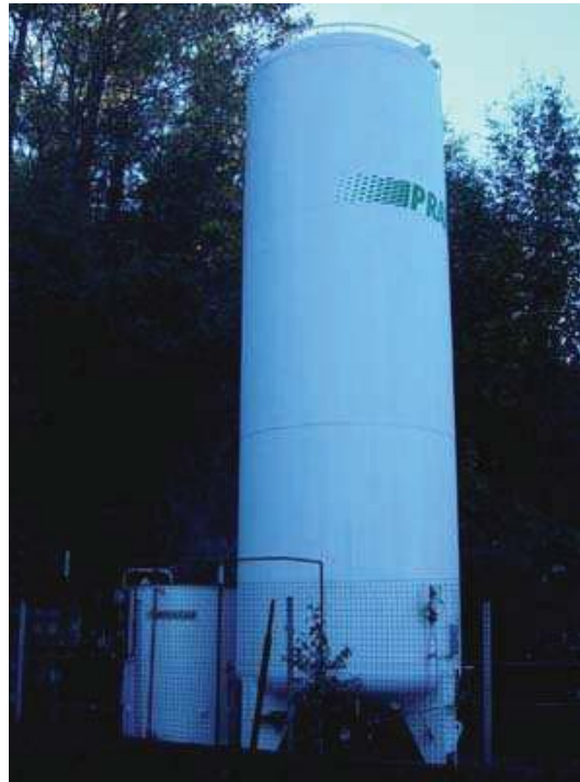
Figura 84. Depósito de Nitrógeno para la inertización
