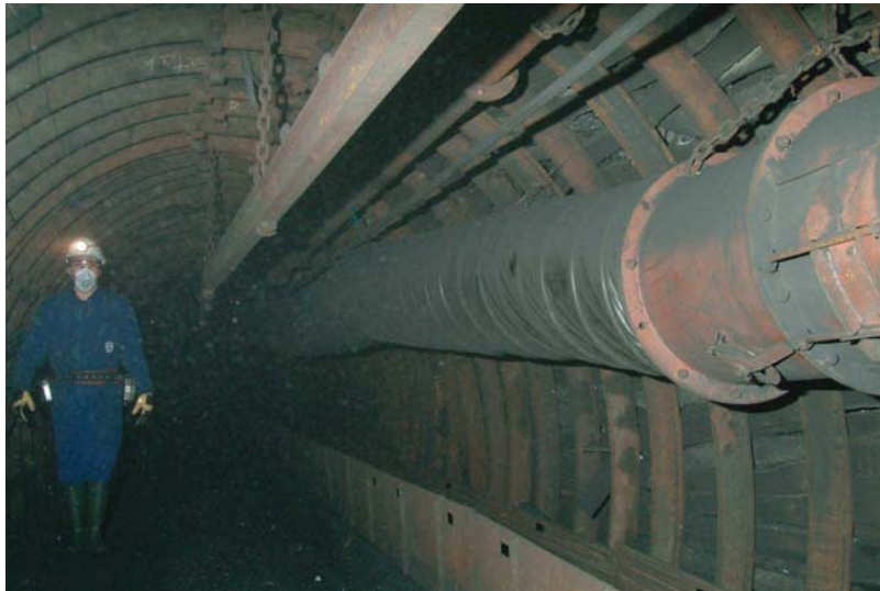
Figura 87. Tubería de ventilación secundaria de una mina
