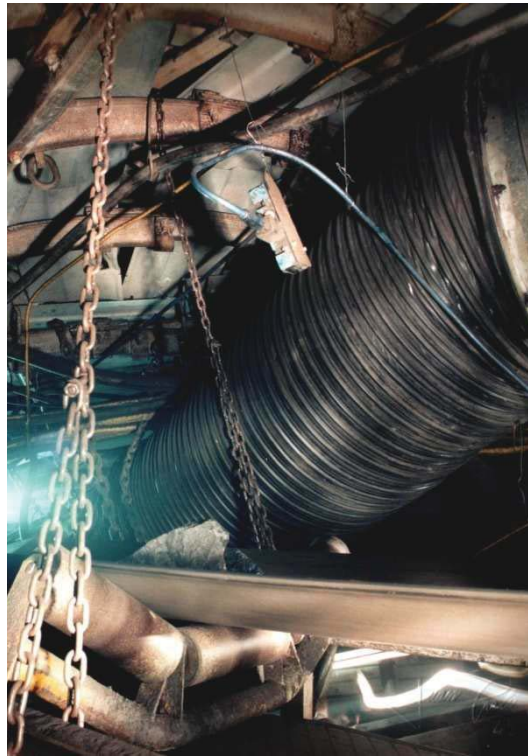
Figura 44. Detector de CO cerca de la cabeza motriz de la cinta transportadora
