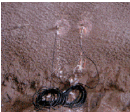
Figura 4- Extensómetro instalado (Sensogeo S.A.).
