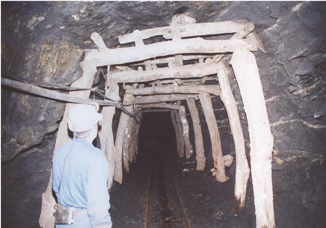
Figura 36 - Sostenimiento de galería con cuadros de madera. Mina Solita de Bembibre (Foto: L.Jordá).
