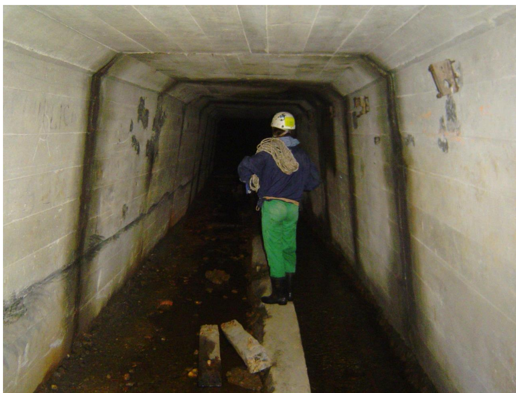
Figura 22 - Filtraciones en mina de Áliva, Cantabria (Foto: R.Jordá), zona reforzada con hormigón.
