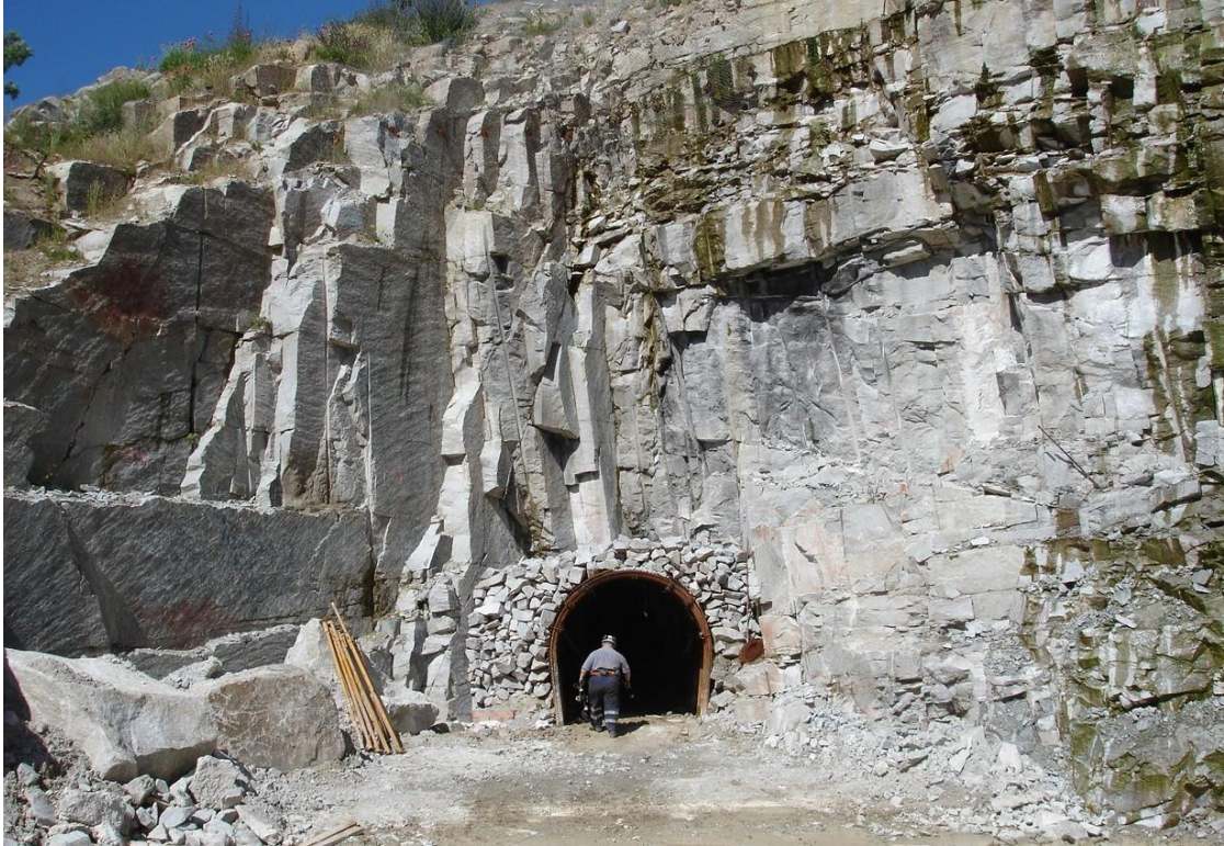
Figura 78 - Emboquille de un túnel en un macizo rocoso diaclasado donde se pueden apreciar el tipo de cuñas resultantes (Inprobras. S.L.).
