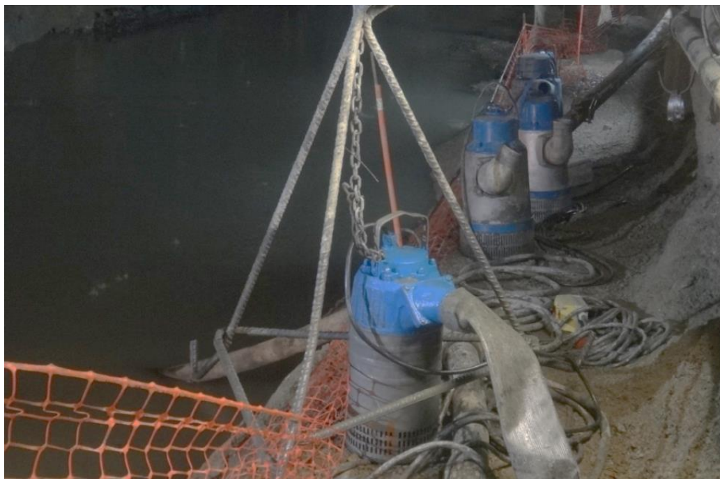
Figura 24 - Bombas de drenaje (Foto: A.Berrocal)
