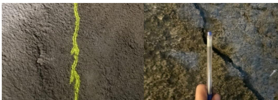
Figura 70 - Grietas en gunita-hormigón proyectado (Fotos A.Berrocal).
