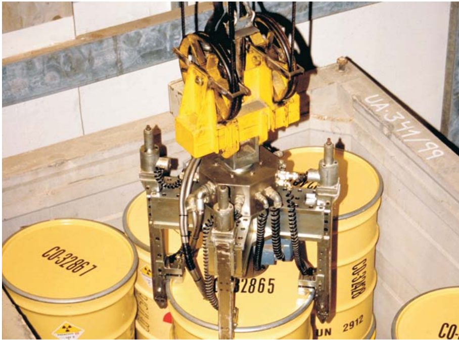
Instalaciones de gestión de residuos radiactivos: disposición de bidones acondicionados en contenedores (El Cabril).
