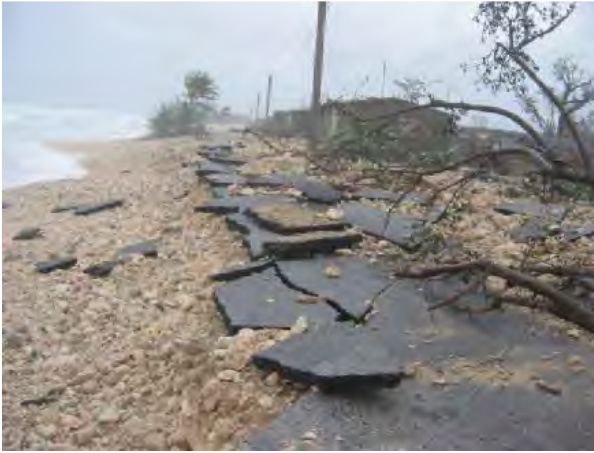
Fig. 7. Efectos del huracán sobre la infraestructura comunitaria en la comunidad de La Bajada
