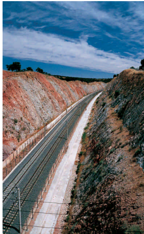
Las grandes infraestructuras viarias van fragmentando y contribuyendo al aislamiento de las poblaciones de lince en Sierra Morena. En la foto, trinchera del AVE a su paso por la Sierra Morena de Córdoba.
