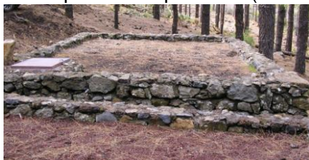
Depósito campamento (20 m3)
