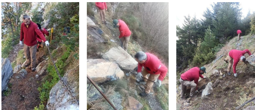
Imatge 29 i 30. Instal·lació de passamans al camí de Comalesbienes i retirada de rocs perillosos. Font: Arxiu fotogràfic del Parc
