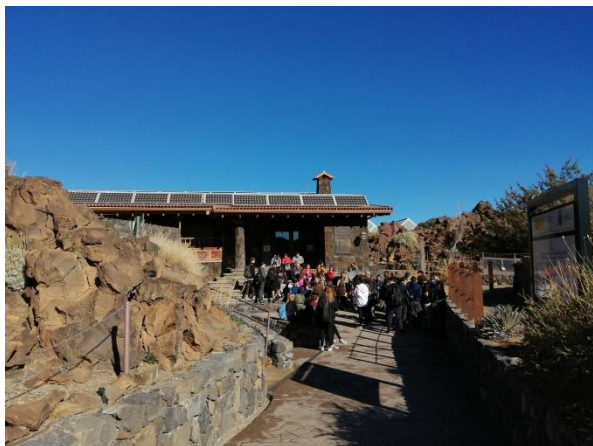
Placas solares en el Centro de Visitantes del El Portillo
