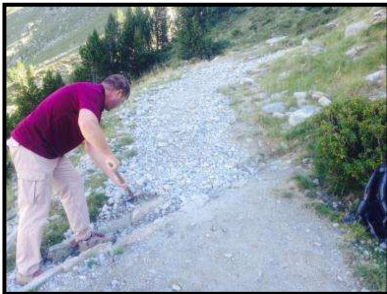
Foto 77: Vaciado de los desagües del camino de El Portarró
