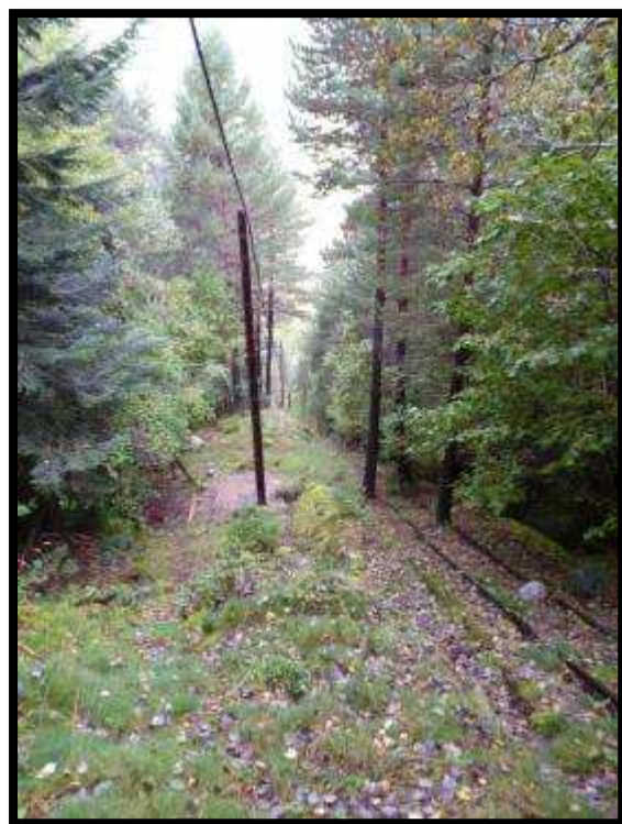
Foto 24: Línea eléctrica del Serrat de Puicastro
