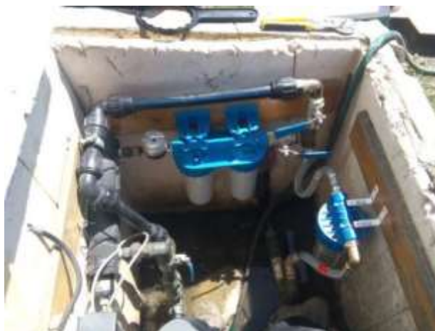
Imagen 23: Instalación para el tractamiento de agua potable del Refugio Pla de la Font. Fuente: archivo fotográfico.
