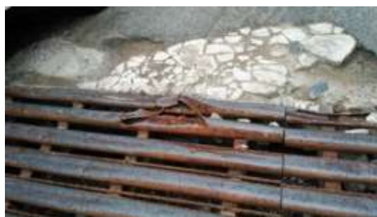
Imagen 25: Daños en el paso canadiense en la entrada del Parque Nacional por la carretera de Sant Maurici. Fuente: archivo fotográfico.
