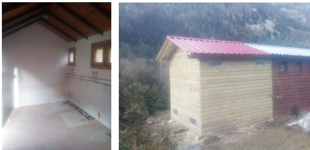
Imatge 23 i 24 Treballs de desmantellament dels elements interiors del mòdul de servei construcció de l'annex per a la sala de calderes. Font: arxiu fotogràfic del Parc.
