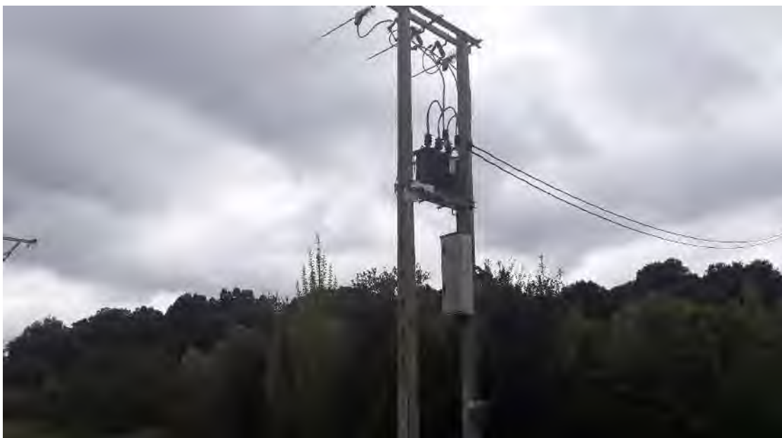
Foto 3: CTI Montehano dentro de la zona de Dominio Público-Marítimo Terrestre.
