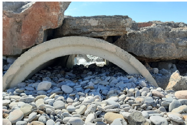
FOTO 4. Estado actual de colmatación del tubo que constituía la salida natural histórica hacia el mar del agua de escorrentía superficial. La dejadez y falta de mantenimiento ha embozado esta salida natural histórica.
