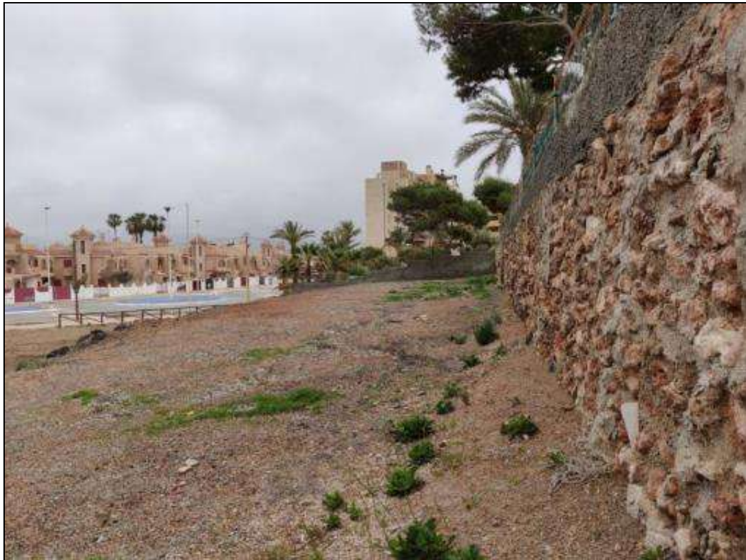
Figura 3. Cerramiento de la vivienda situada sobre el cabezo Punta de Nares (parcela nº 1). Flanco Oeste. Talud no incluido en DPMT
