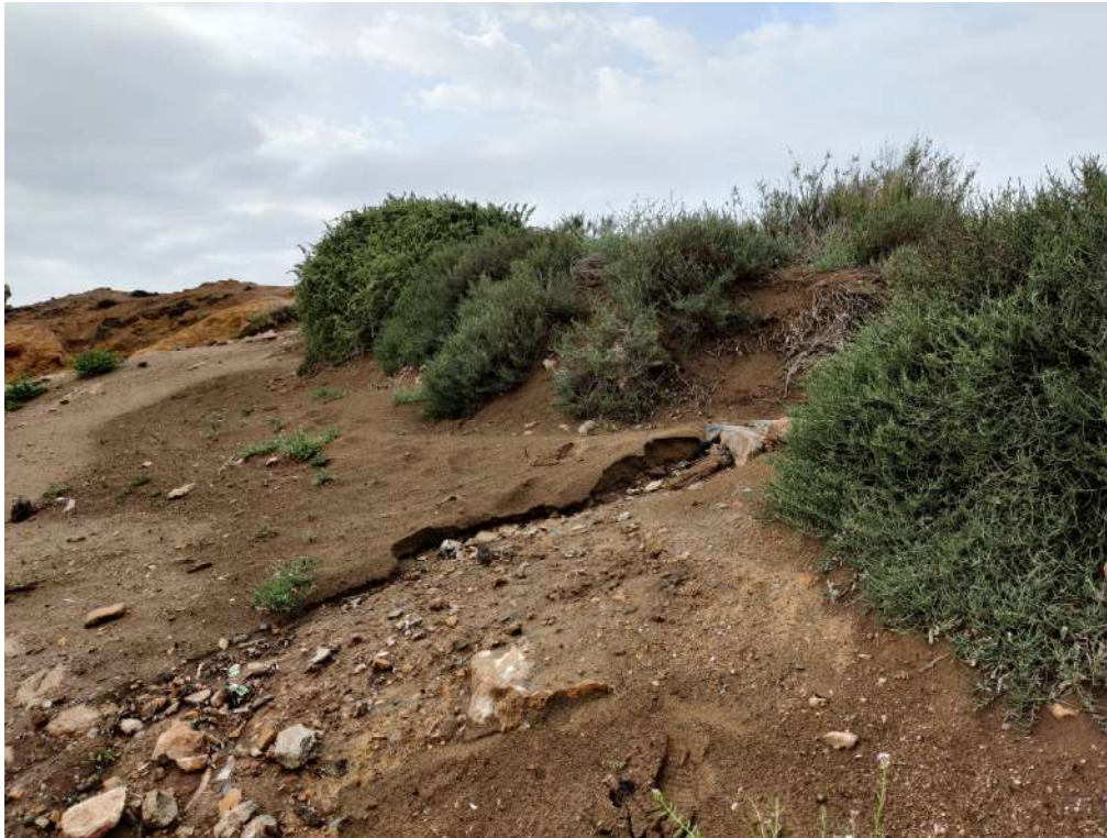
Figura 1. Detalle del ascenso de las arenas en el talud de Punta de Nares
