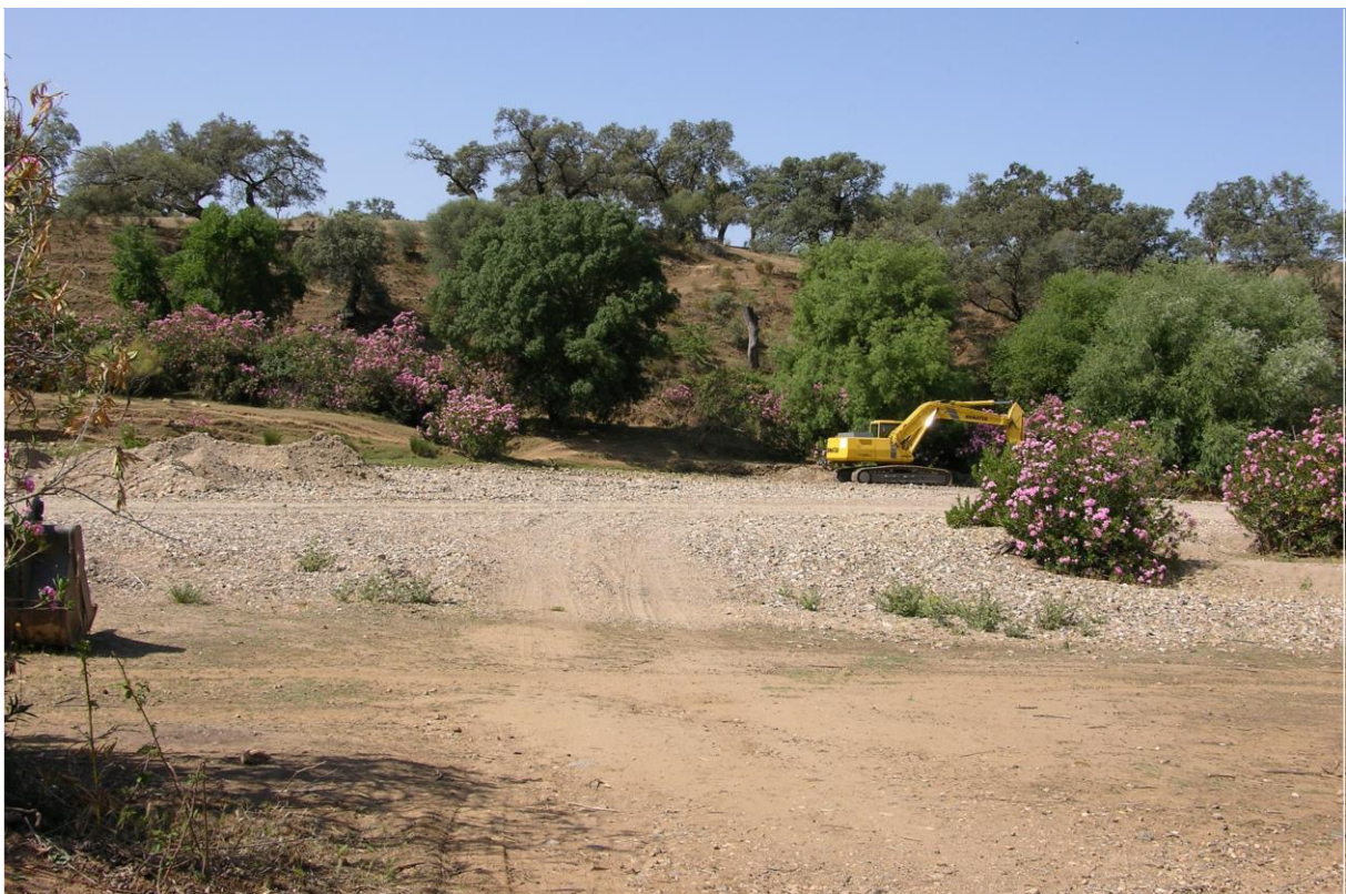
Extracción de áridos en la ribera de Chanza cerca de Aroche (Huelva).
