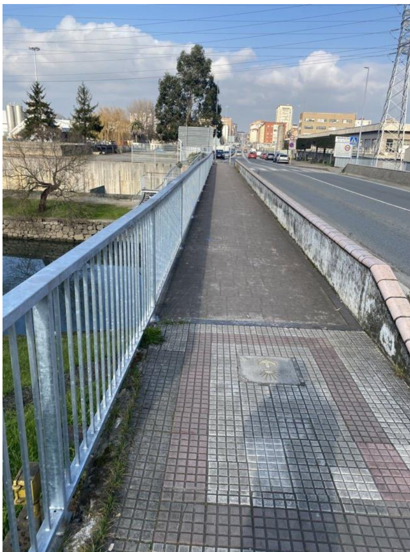
Ilustración 4. Detalle de la calzada por donde discurre la canalización de 6 conductos de PVC por el puente de la Avenida Bilbao (Fuente: Telefónica de España. Año 2022)
