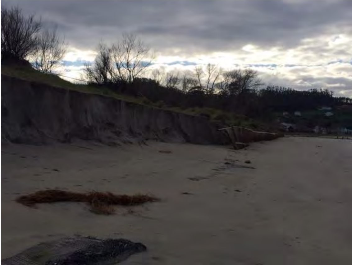
Imagen 8: Daños causados por el temporal acaecido en febrero de 2020
