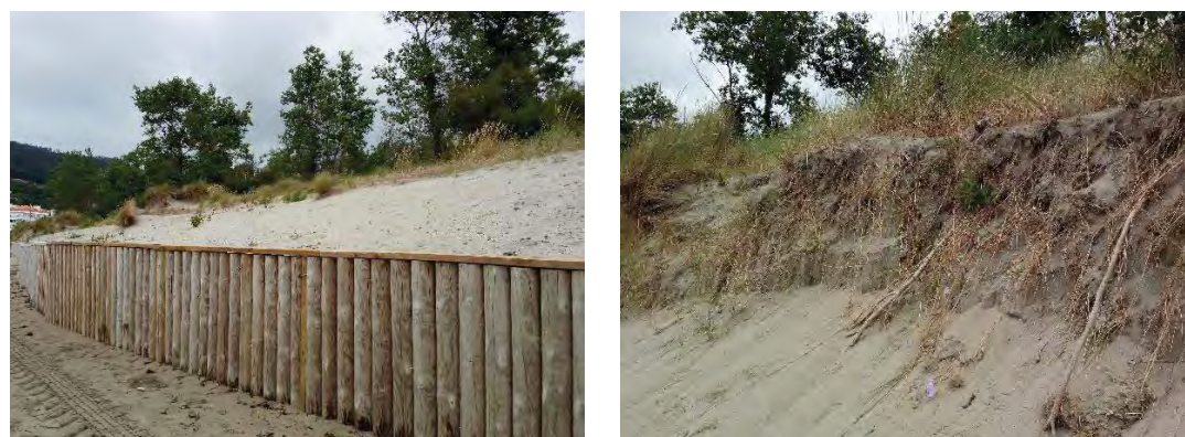
Figura 6. Rollizos de madera descubiertos y talud de la duna.
