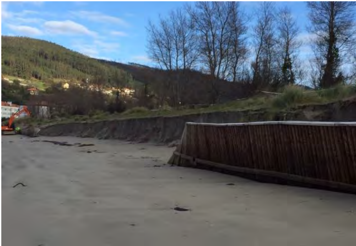
Imagen 3. Erosión provocada por el temporal de febrero de 2020.
