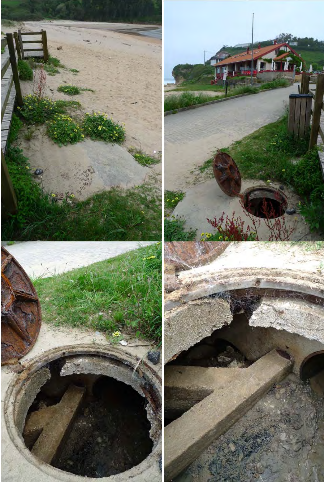
Arqueta con rebosadero que posibilita el alivio de las aguas residuales ante la eventual parada de las bombas o por la incapacidad de bombeo de las mismas
