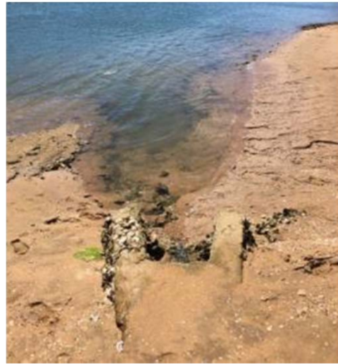
Salida del colector (boquilla parcialmente enmascarada)
