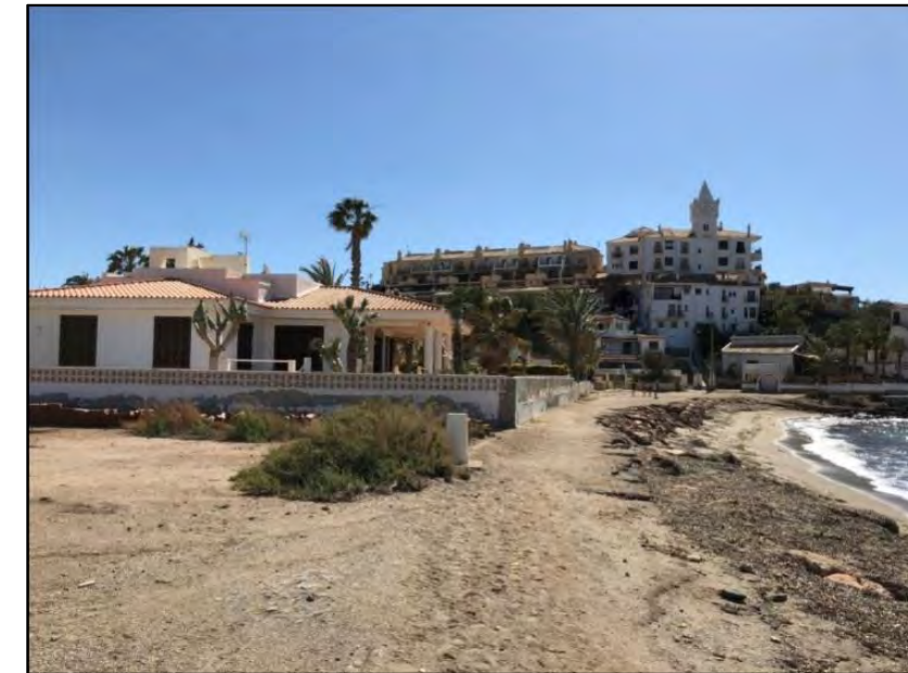
Figura 2. Vertido de escollera no autorizado
