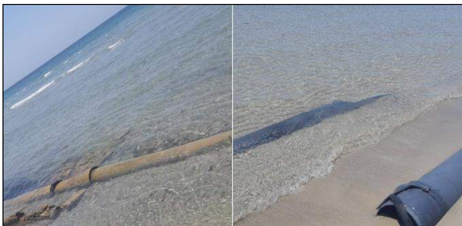
Ilustración 33. Tubería desenterrada en la Playa de la Llana
