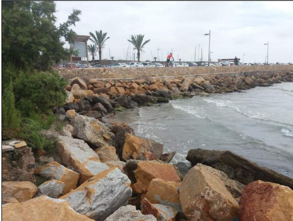
Ilustración 8. Escollera existente en el contradique del Puerto y en la zona de playa
