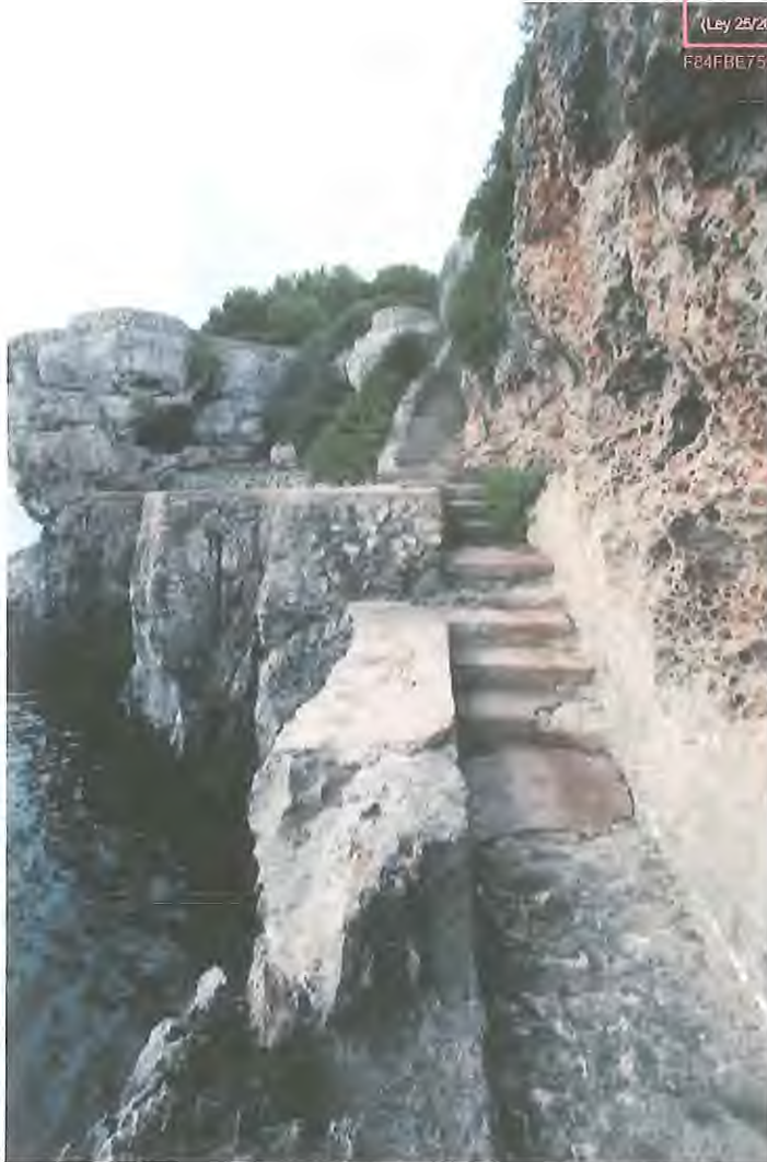
- Solera en mal estado
