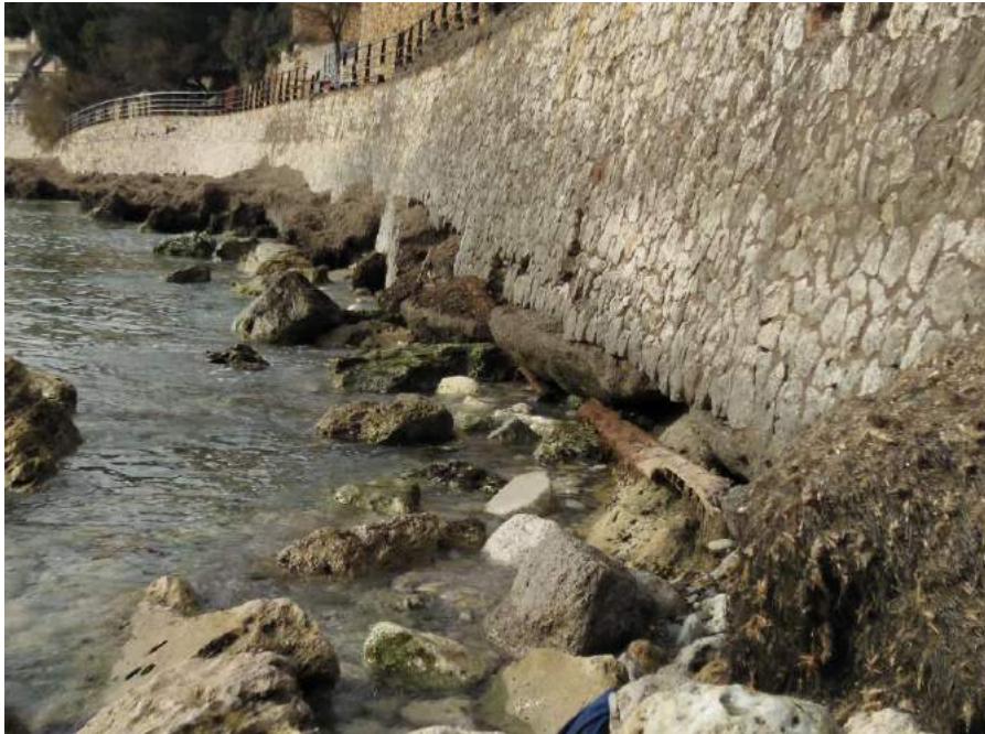
Figura 10.- Estado de la zona central del muro del paseo, previamente a la ejecución de las obras de emergencia.
