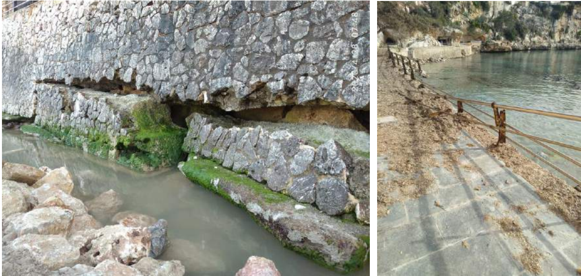
Figura 4.- Daños provocados por el temporal "Gloria" en el paseo marítimo
