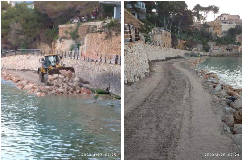
Figura 11.- Ejecución de la bancada de escollera y del camino provisional de acceso a la obra.
