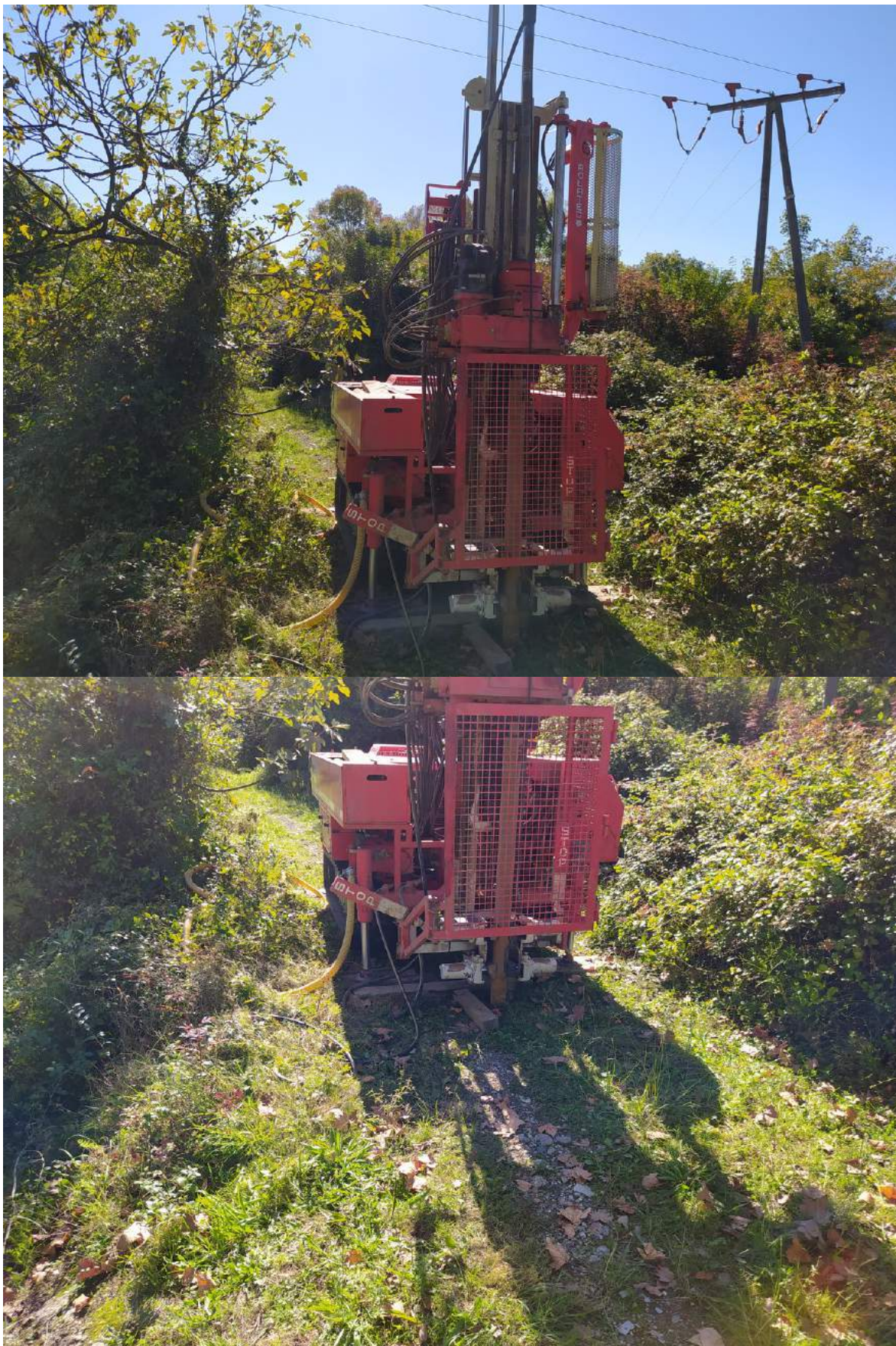
(P-21-24) RECUPERACIÓN AMBIENTAL DE LAS MARISMAS DE SAN LORENZO "PLAIAUNDI" EN LOS TÉRMINOS MUNICIPALES DE IRUN Y HONDARRIBIA ANEXO 12: REPORTAJE FOTOGRÁFICO
