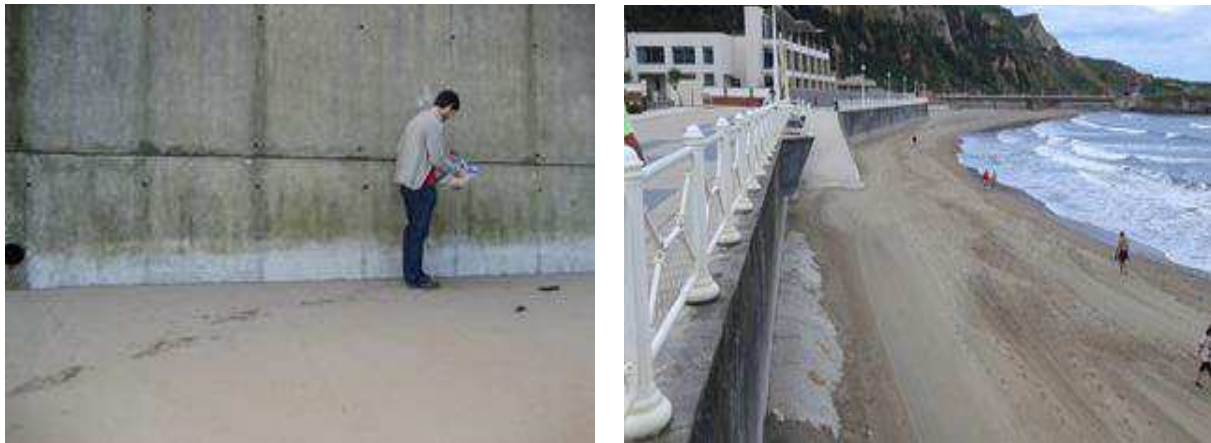
Figura 16. Erosión de la base del muro de Salinas (parte basal más blanquecina), a la izquierda en marzo del 2008 y a la derecha en junio de 2016, visible al fondo.
