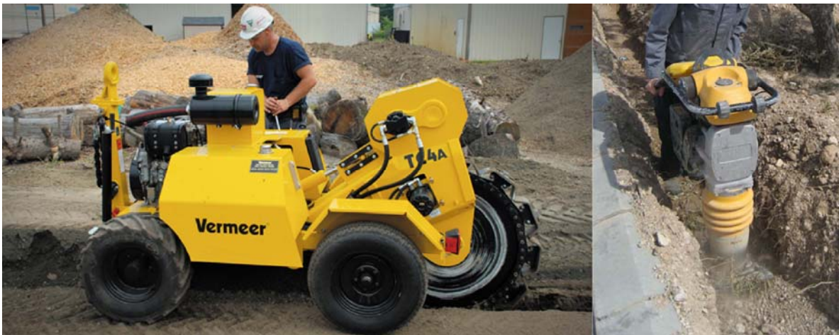
Fotos 29 y 30. Compactadora, manual (derecha) y compactadora motorizada, para compactado de zanjas y de la solera del nuevo transformador.
