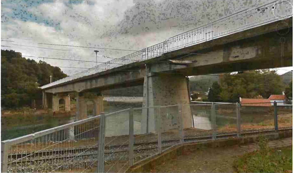
Puente sobre la ría Mundaka y ffcc bajo el vano 3 (t.m. Busturia)
