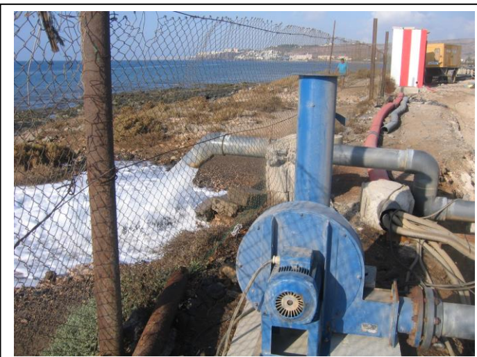
FOTOGRAFÍAS N° 3 Y 4.- MUESTRAN ALGUNAS DE LAS INSTALACIONES Y MECANISMOS EN EL EXTERIOR DEL POZO
