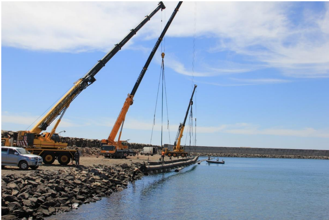
Ilustración 28 Lanzamiento de los tramos de conducción desde el muelle de la central térmica
