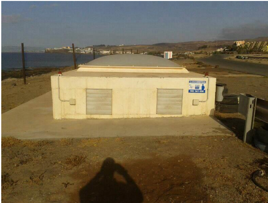
Ilustración 10 Estación de Bombeo. Exterior
