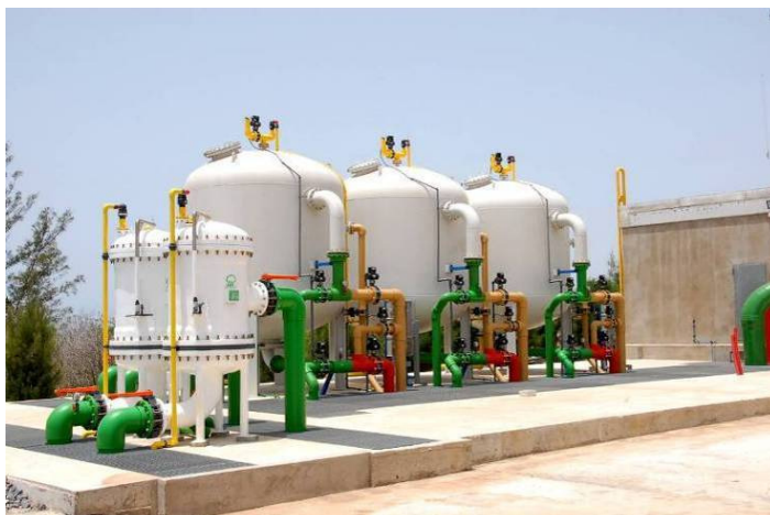
Ilustración 10 Planta Desalinizadora Maspalomas I. Plataforma de filtros.
