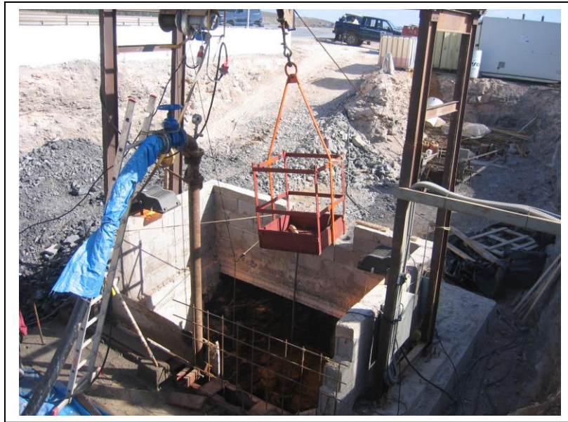
FOTOGRAFÍA N°1.- MUESTRA UNA VISTA DEL POZO CONSTRUIDO.
