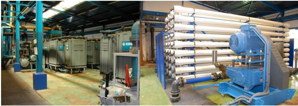
Ilustración 8 Planta Desalinizadora Maspalomas I. Módulos de desalinización por E.D.R. y O.I.
