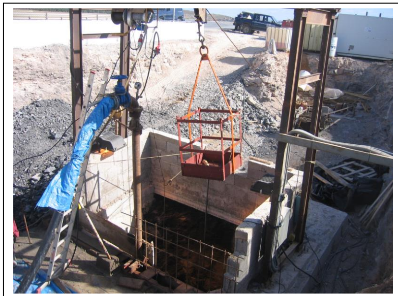
FOTOGRAFÍA N°1.- MUESTRA UNA VISTA DEL POZO CONSTRUIDO.
