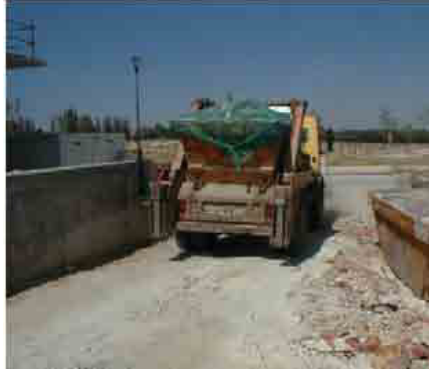
Figura 1 Traslado de volquete con residuos inertes, tapado con lonas para prevenir la contaminación atmosférica del medio.
