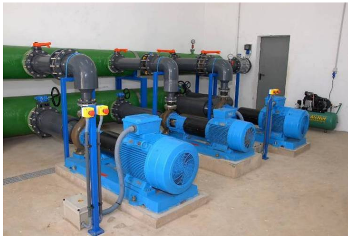
Ilustración 9 Planta Desalinizadora Maspalomas I. Sala de bombas de transferencia.
