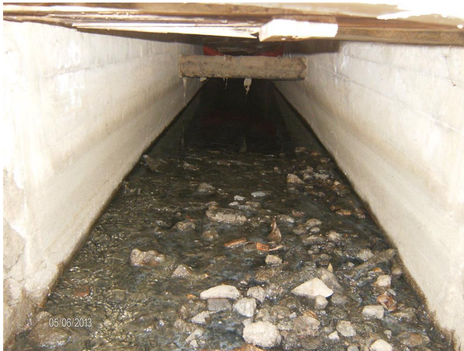
Canal de acometida al pozo principal
