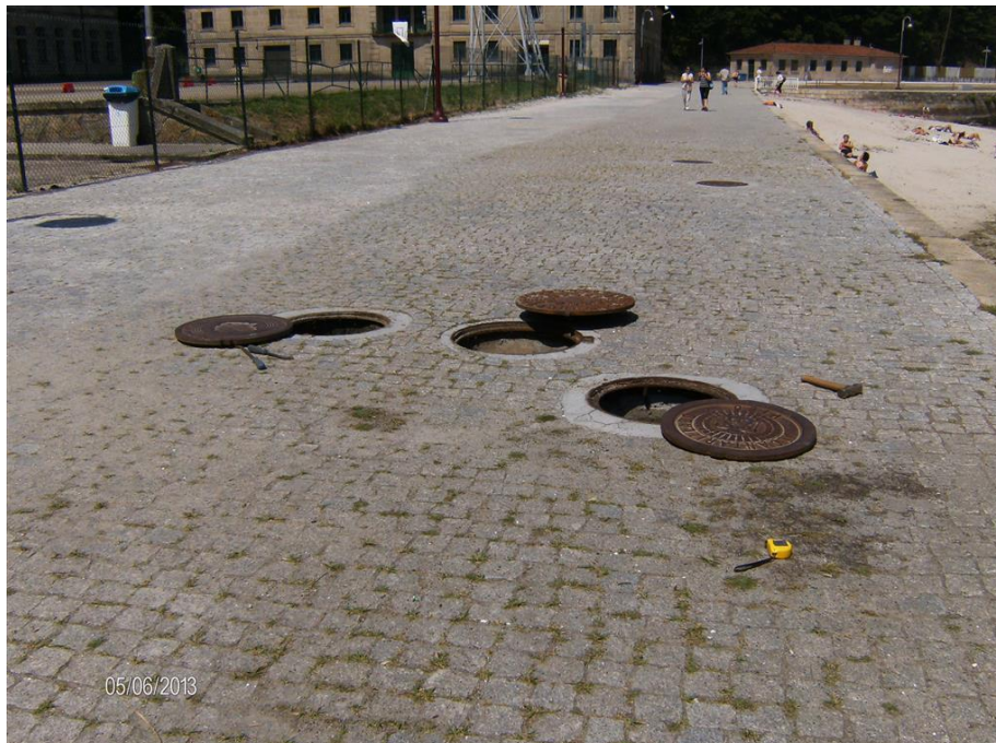
Imagen de los pozos de conexión en el borde del muelle.
