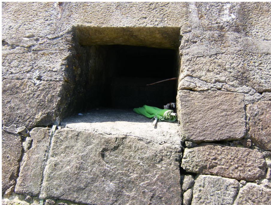
Salida del rebosadero hacia el mar.
