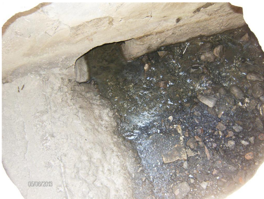
Interior del pozo en el que se aprecia la derivación del canal hacia el colector y la pared del rebosadero.
