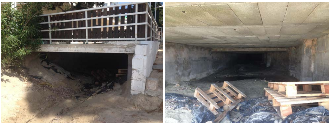
Fotografía 2. Imágenes del estado actual del punto de vertido de la red de aguas pluviales al mar. Fuente: propia.
