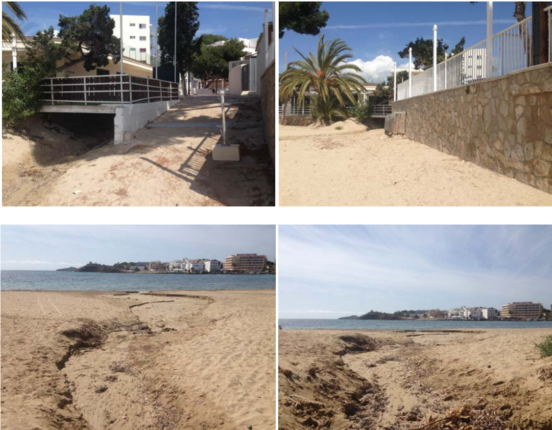
Fotografía 3. Imágenes del punto de vertido actual y de las cárcavas formadas en la playa debido al arrastre de aguas. Fuente: propia.
