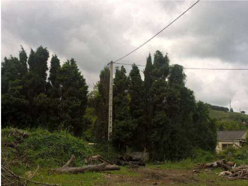
Fotografía nº25: Poste de hormigón y línea eléctrica de BT existente.
