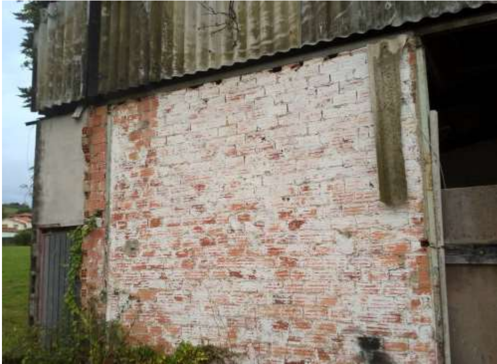
Fotografía nº17: Pared Sur de nave de servicios auxiliar. Pared de ladrillo a cargar, enlucir y pintar.
