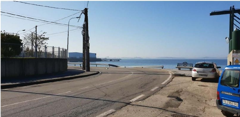
Vista de la curva de la calle Valle Inclán antes de encarar la recta hacia la playa de Canelas. Observamos el pésimo estado del firme, los cambios de rasante y el deterioro del bionda de protección en la curva.
