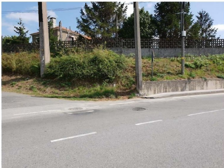
Imagen de la reducida acera de apenas 90cm en la intersección entre las calles Valle Inclán y Rúa Canelas.
