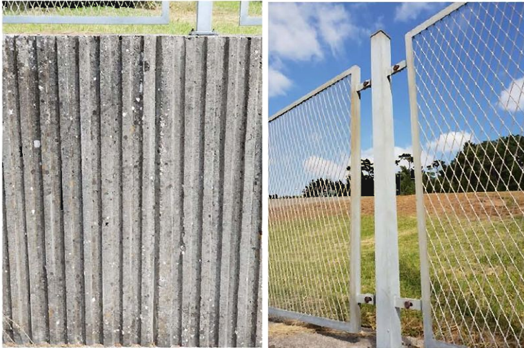
Imágenes de la textura del muro existente (izquierda) y de la valla a sustituir (derecha).
