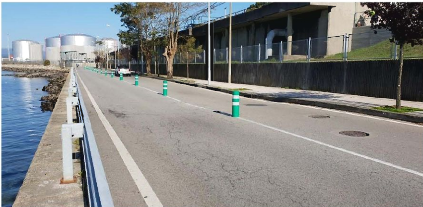
Imagen del hundimiento del firme a la altura del aliviadero de la EDAR.
