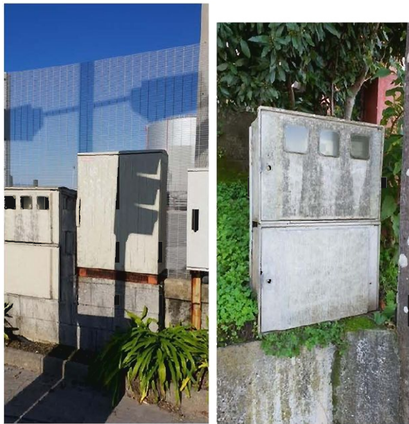
Imagen de los cuadros de mando existentes.
