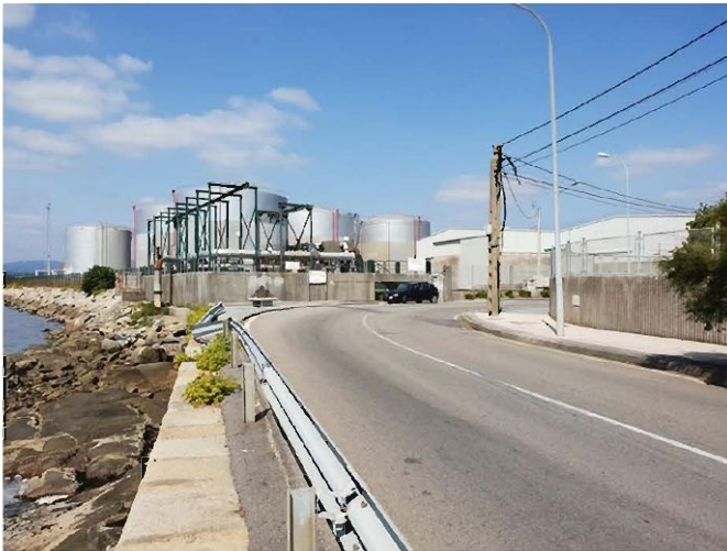
Vista de la curva de la calle Valle Inclán sentido Vilagarcía centro a la altura de la planta de pretratamiento de la EDAR. Se observa el pésimo estado del firme, los cambios de rasante y el deterioro del bionda de protección en la curva.
