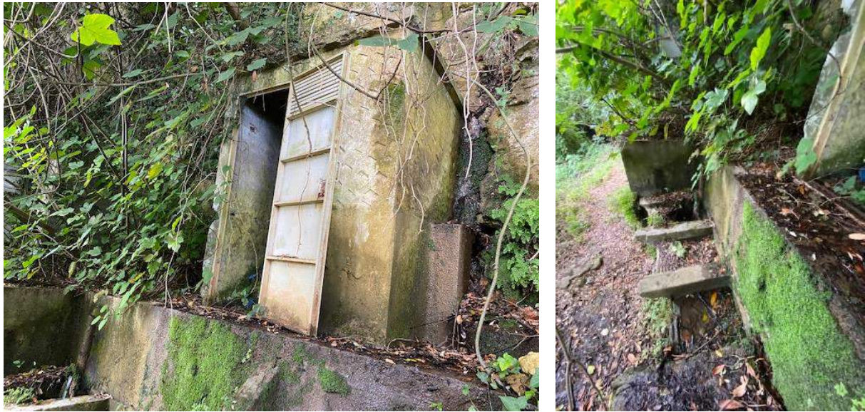
Imagen 27.- Estado actual del antiguo lavadero.
