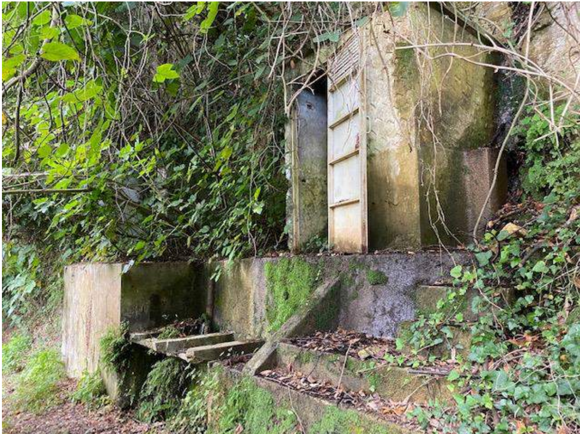
Imagen 8.- Estado actual del lavadero de Suances.
